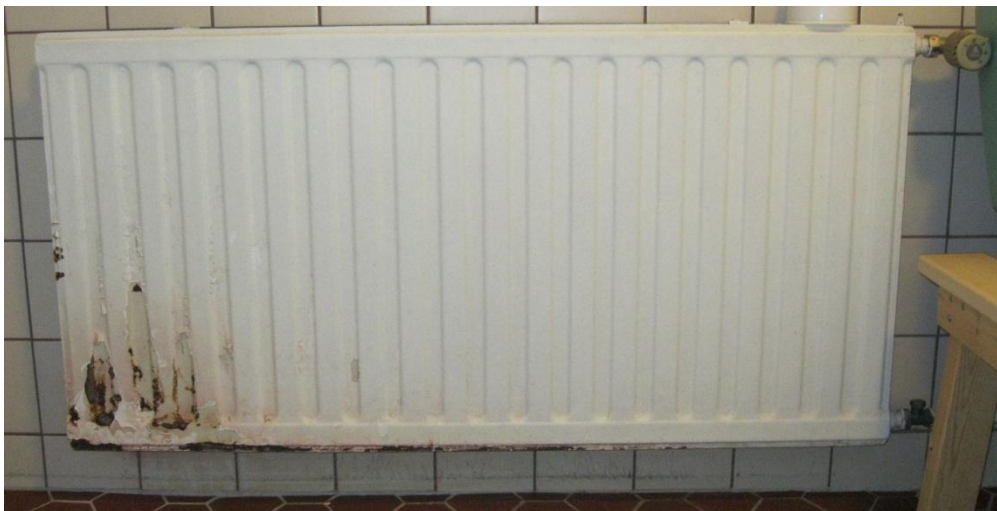
Kuvio 7. Suihkuhuoneen lämmityspatteri
