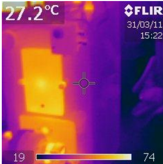
Kuvio 8. Öljykattilan lämpökuva
