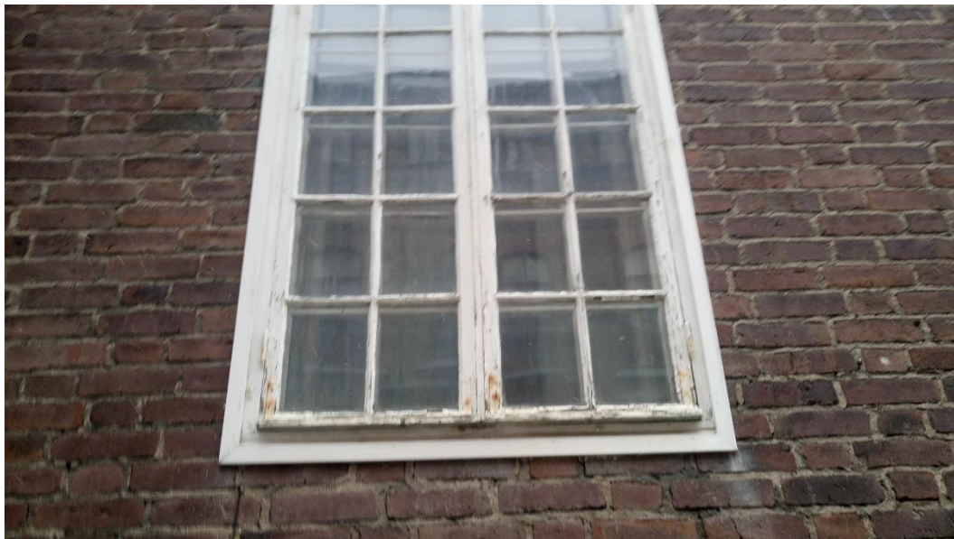
Figur 5. Fönster där färgen börjat flagna.
