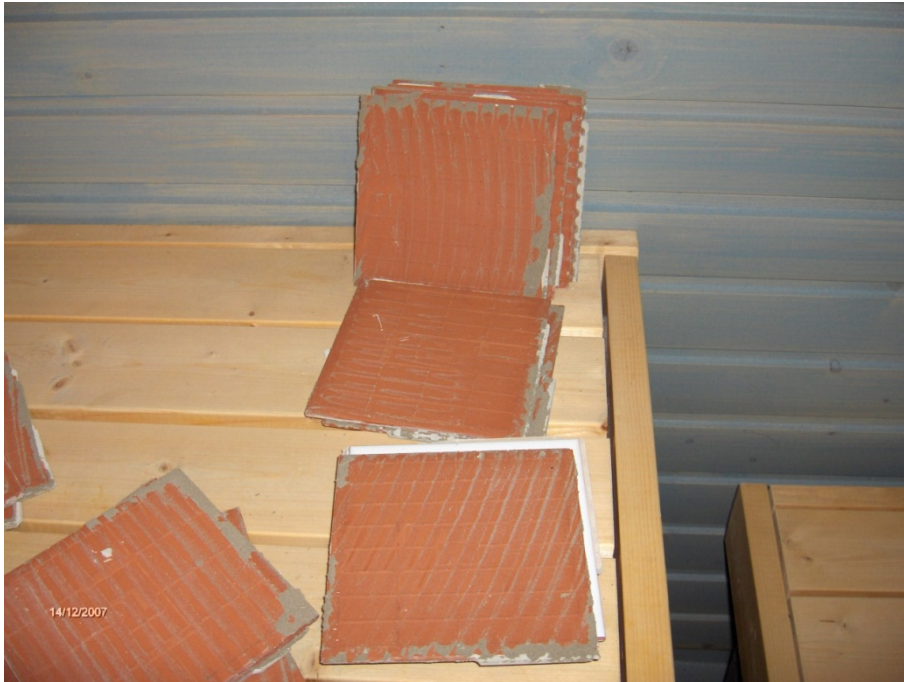
KUVA 3: Seinältä tippuneita laattoja (Kuva: Lemminkäinen 2005)
