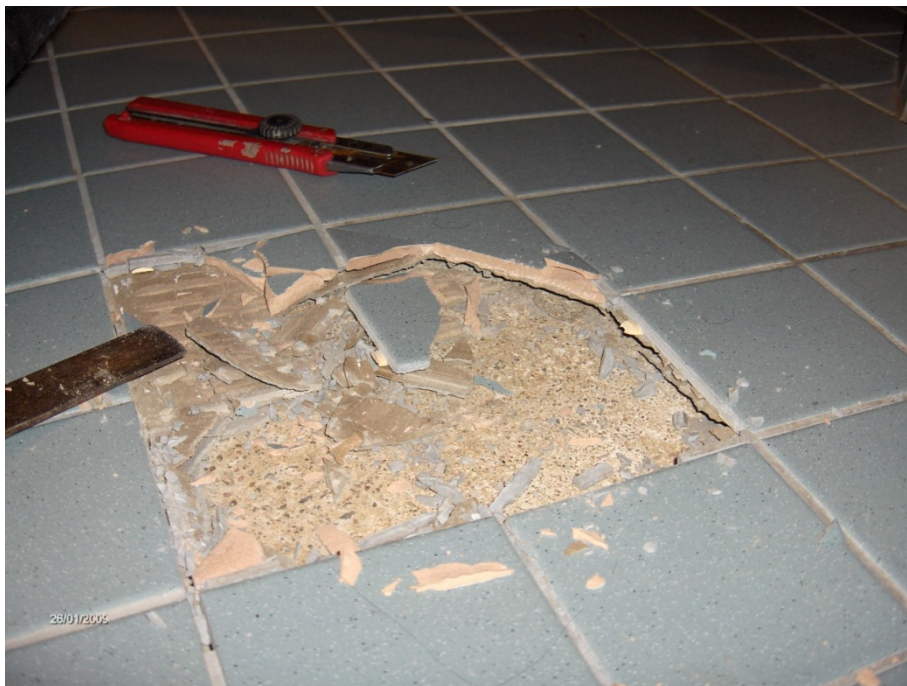
KUVA 5: Vedeneristys irronnut betonialustasta (Kuva: Lemminkäinen 2005)
