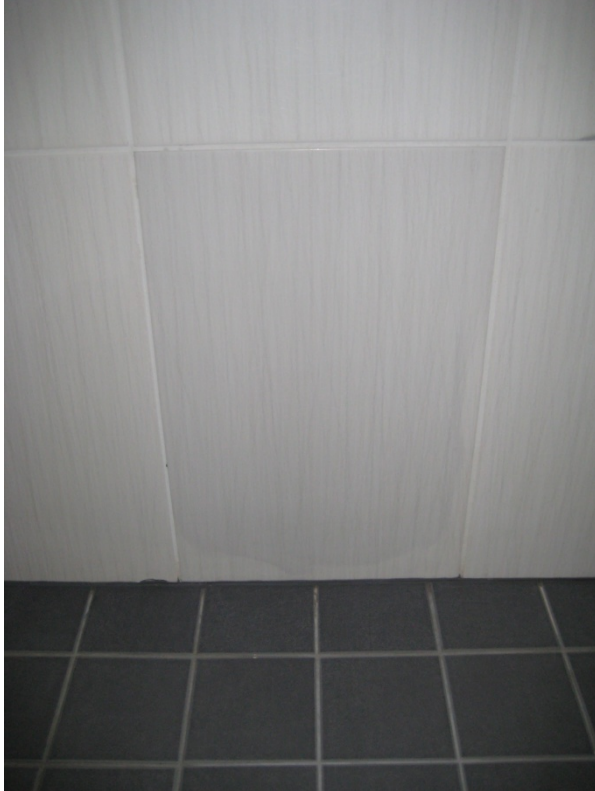
KUVA 1: Seinälaattojen alaosa värjäätynyt (Kuva: Lemminkäinen 2009)
