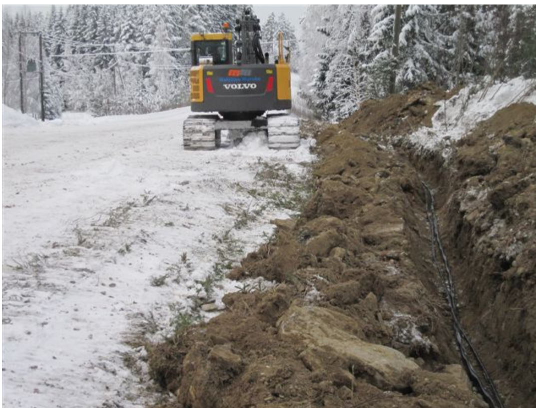
Kuva 2. 20 kV:n sähkökaapeli on asennettu luvattomasti maantieojaan (Kuva: Antti Piirainen 2011)
