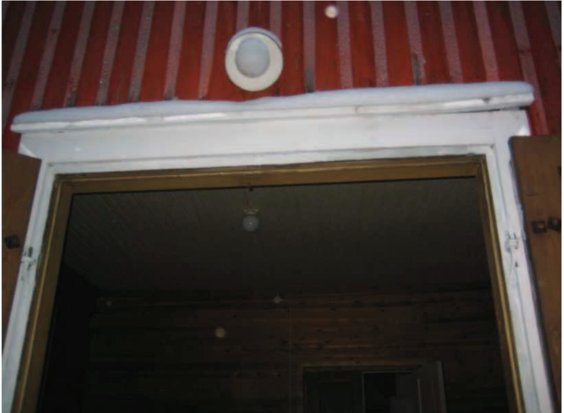
Kuva 7. Kylmän makasiinin ulko-oviaukko ulkoapäin kuvattuna. Kuvassa näkyy taustalla pariovellinen purettava väliseinä.
