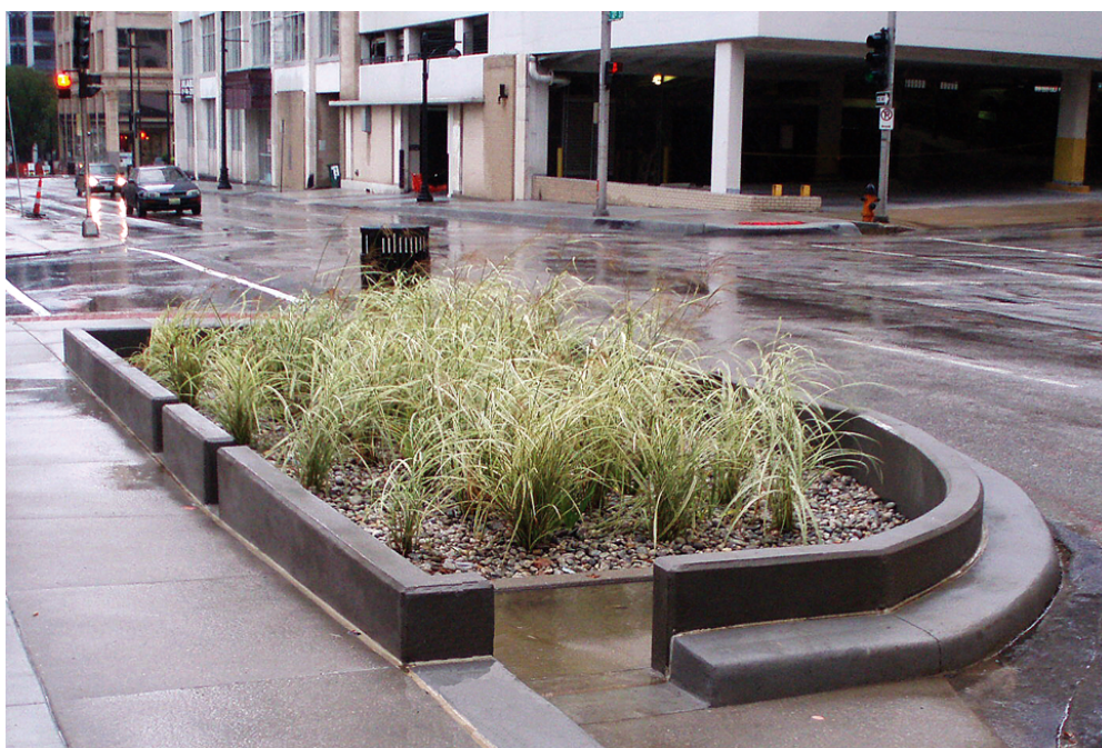
Kuva 7. Katuvesien imeytyspainanne. Kiveyksessä olevasta aukosta vedet johtuvat painanteeseen (Vegtech/Envire VRJ Group 2009).
