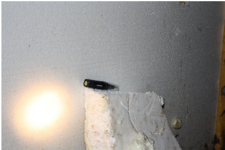
Kuva 11. Mittarin asema ryömintätilan seinustalla.
