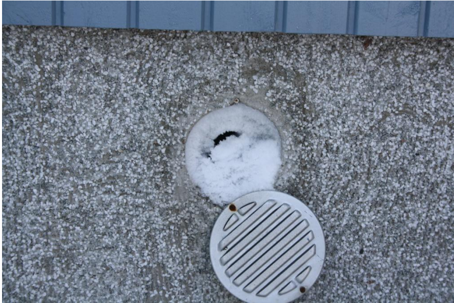
Kuva 6. Lumi on tukkinut ilmanvaihtokanavan.
