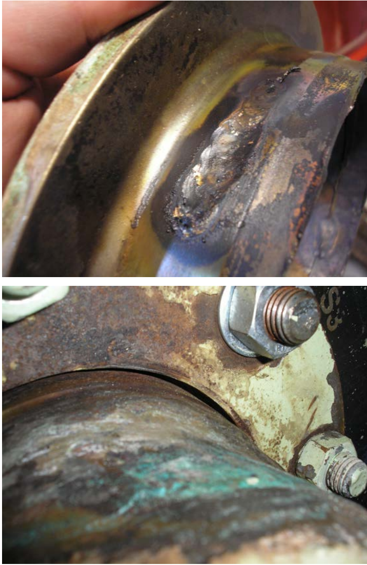
Kuvat 14ja 15: Nikkeli-kupariputken sauman vajoama ilman juuritukea.
