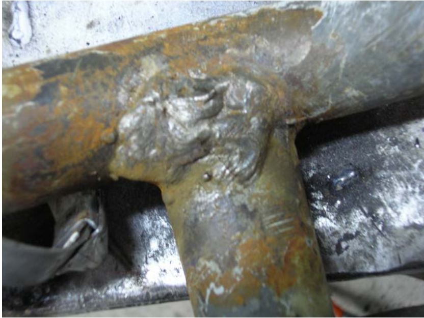
Kuva 18: Halkeama kertaalleen paikatussa teräsputkessa.
