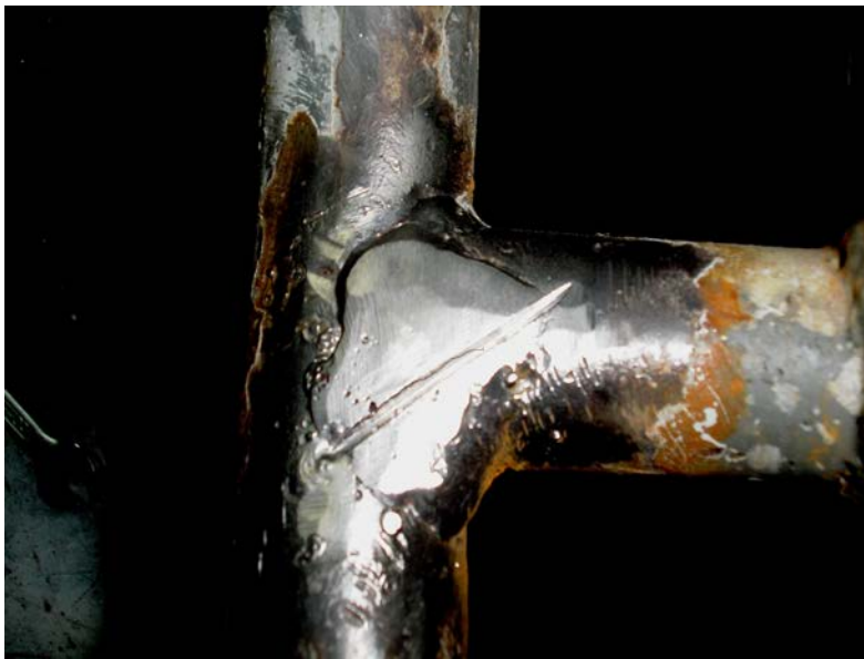
Kuva 17: Murtumakohtaa avattu kulmahiomakoneella.
