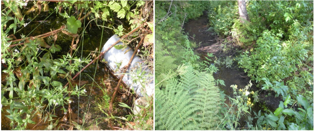
KUVA 11. Purkuputken pää on syytä pitää auki tukkeutumisen estämiseksi (Teräväinen 2010).
