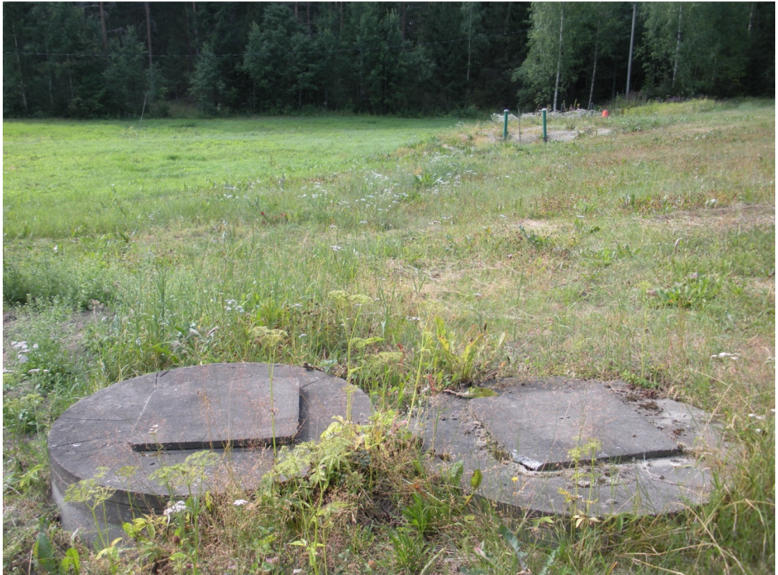
KUVA 13. Vanhat betoniset saostuskaivot palvelevat kiinteistöllä edelleen (Teräväinen 2010).
