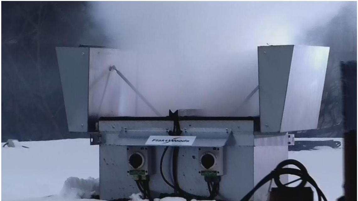
Kuva 2. Savunpoistopuhallin toiminnassa rakennuksen katolla [3, ajassa 7.58]
