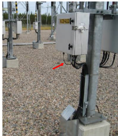
Kuva 21 a) Erottimen maadoitus
