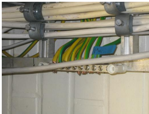
Bild 8. Exempel på bristfällig märkning.
