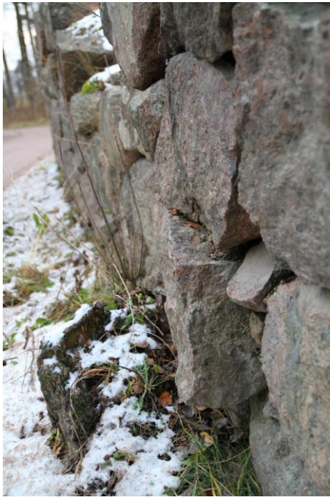
Kuva 12. Raunio nro 83. Muurissa pullistuma.
