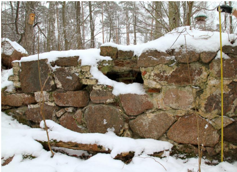
Kuva 19. Raunio nro 83. Muurattu tuuletusaukko sekä vanhoja korjauksen jälkiä.
