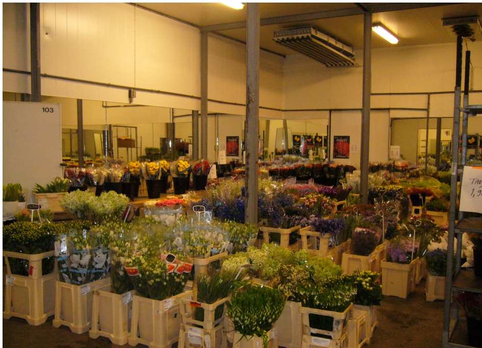
Kuva 1. Helsingin Kukkatoimitus Oy:n leikkokukkien varastointikylmiö.
