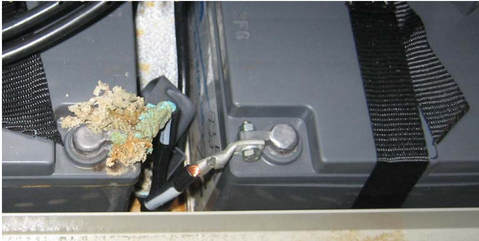
Kuva 13. Suljetun lyijyakun pahasti korroosiolle altistunut liitos.
