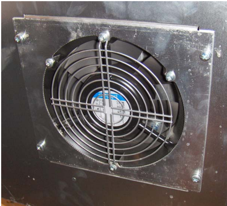
Kuva 12. Vuosihuollon aikana tarkastettava UPS-laitteessa sijaitseva tuuletin.
