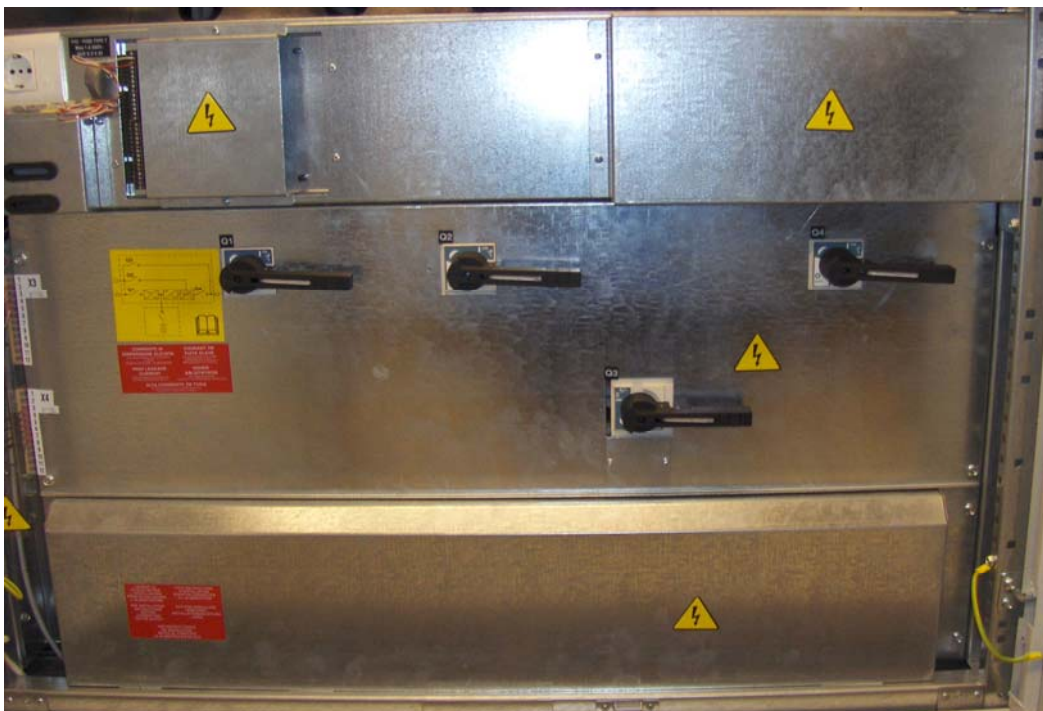
Kuva 10. Esimerkki suuritehoisen kahdenmuunnoksen online UPS:n käyttökytkimistä.
