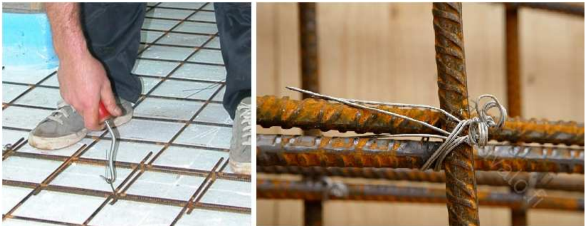
Kuvio 9. Vasemmalla sidotaan rauditusverkkoja toisiinsa raudituskoukkaa käyttäen. (Rakentaja.fi, [Viitattu 22.3.2011].) Oikealla rauditusteräksien sidonta, jossa käytetty teräslankaa ja raudituskoukkaa. (Vastavalo.fi, [Viitattu 22.3.2011].)
