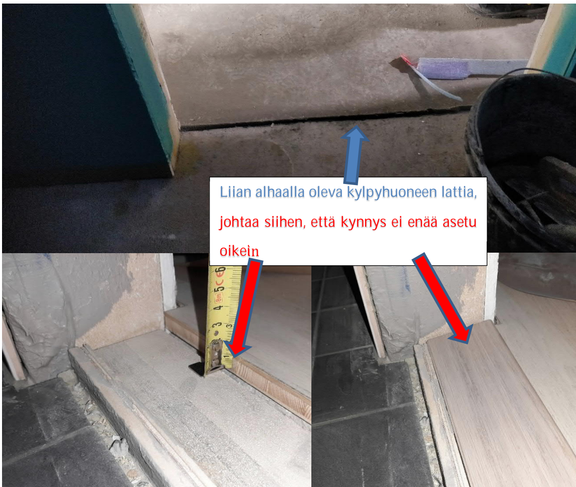
Kuva 4 Kylpyhuoneen ja huoneen liittymäkohta, joka on tehty väärin
