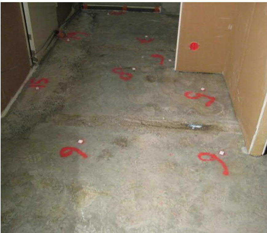
Kuva 13 Lattia, joka on valmiina plaanoa varten. (Korot mitattu ja merkattu sprayllä lattiaan, aukot kitattu, imuroitu, praimerit levitetty ja korkomerkit leikattu ja laitettu lattiaan kiinni)
