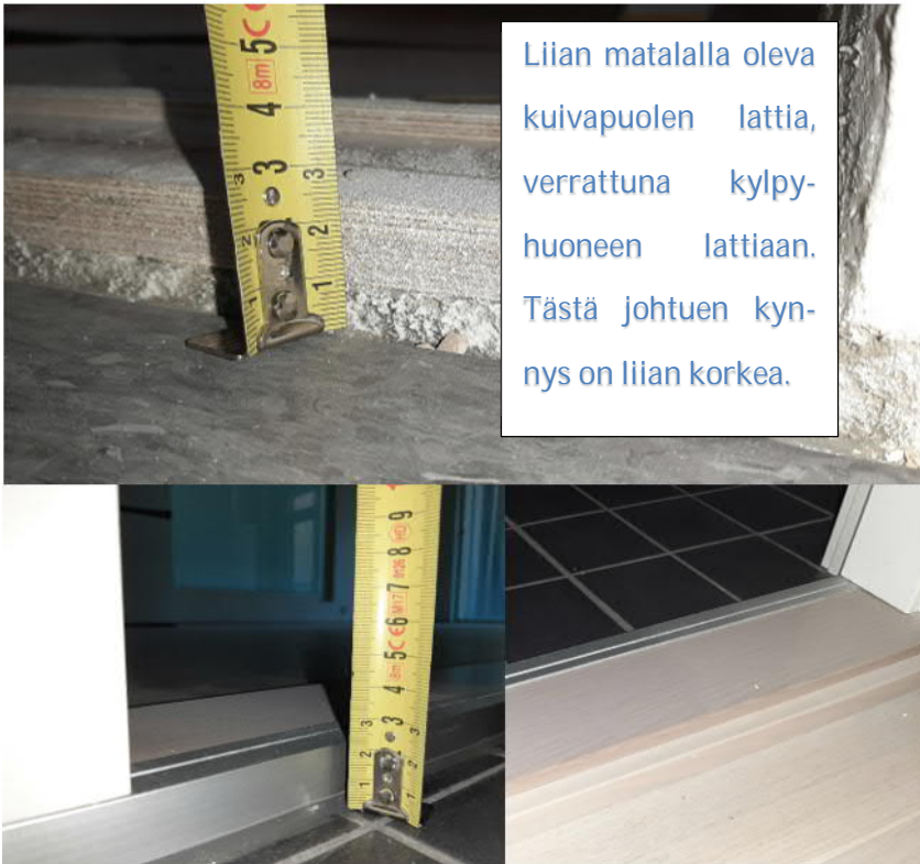
Kuva 6 Liian korkea kylpyhuoneen kynnyks
