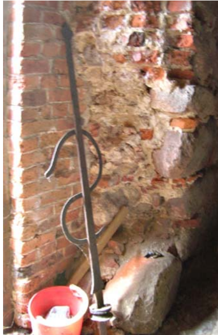
Kuva 28. Ulko-oven vieruksesta kellarin sisäpuolella muuraus on vaurioitunut pahoin. Lähes kaikki tiilet ovat haljenneet.
