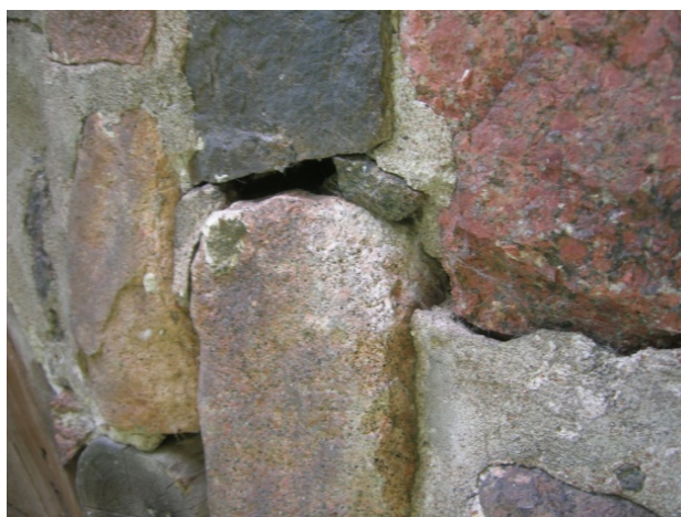
Kuva 27. Laasti irtoilee kivien saumoista monin paikoin kellarin ulkoseinillä.
