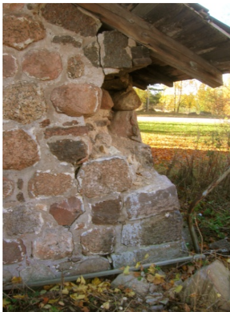
Kuva 24. Kellarin koillisnurkka on vahingoittunut pahoin. Kuva on otettu idästä.
