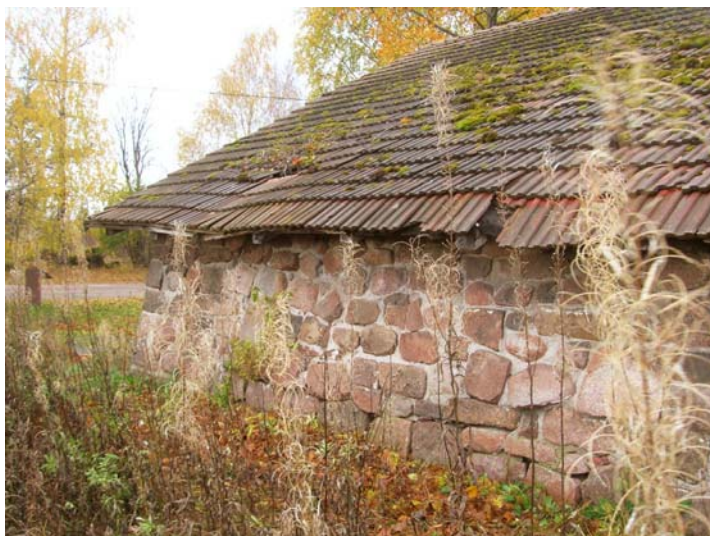
Kuva 29. Etelälappen räystääs on todella huonossa kunnossa. Alimman rivin tiilistä suuri osa on pudonnut maahan aluslautojen petettyä.
