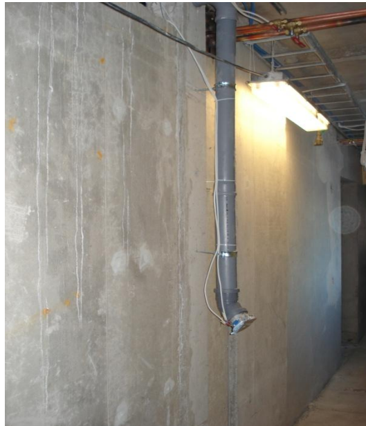
Kuva 4. Keskuspölynimurin putki kerroksessa.
