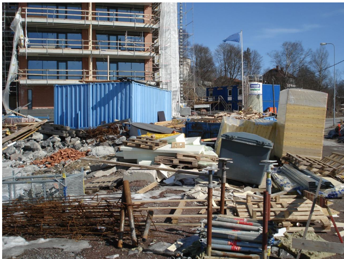
Kuva 1. Huonosti hoidettu työmaan jätehuolto.
