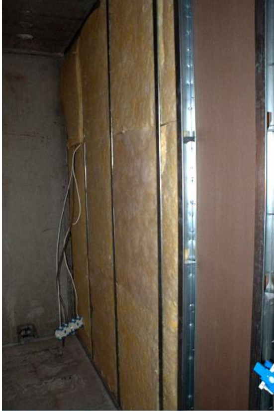
Kuva 7. Seinän sisään asennettua mineraalivillaa. Kuvan tilanteessa seinän takana on hissikoulu, josta kantautuvaa ääntä pyritään vaimentamaan mineraalivillalla.
