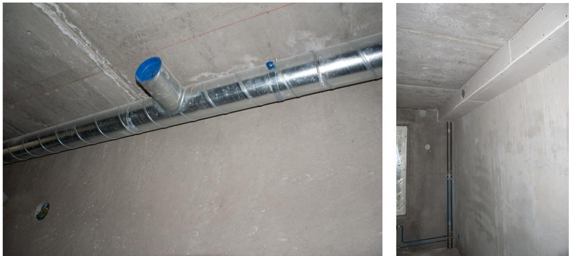
Kuva 3. Vasemmassa kuvassa näkyy ilmanvaihtoputki. Oikeassa kuvassa putken ympärille on rakennettu kotelo.
