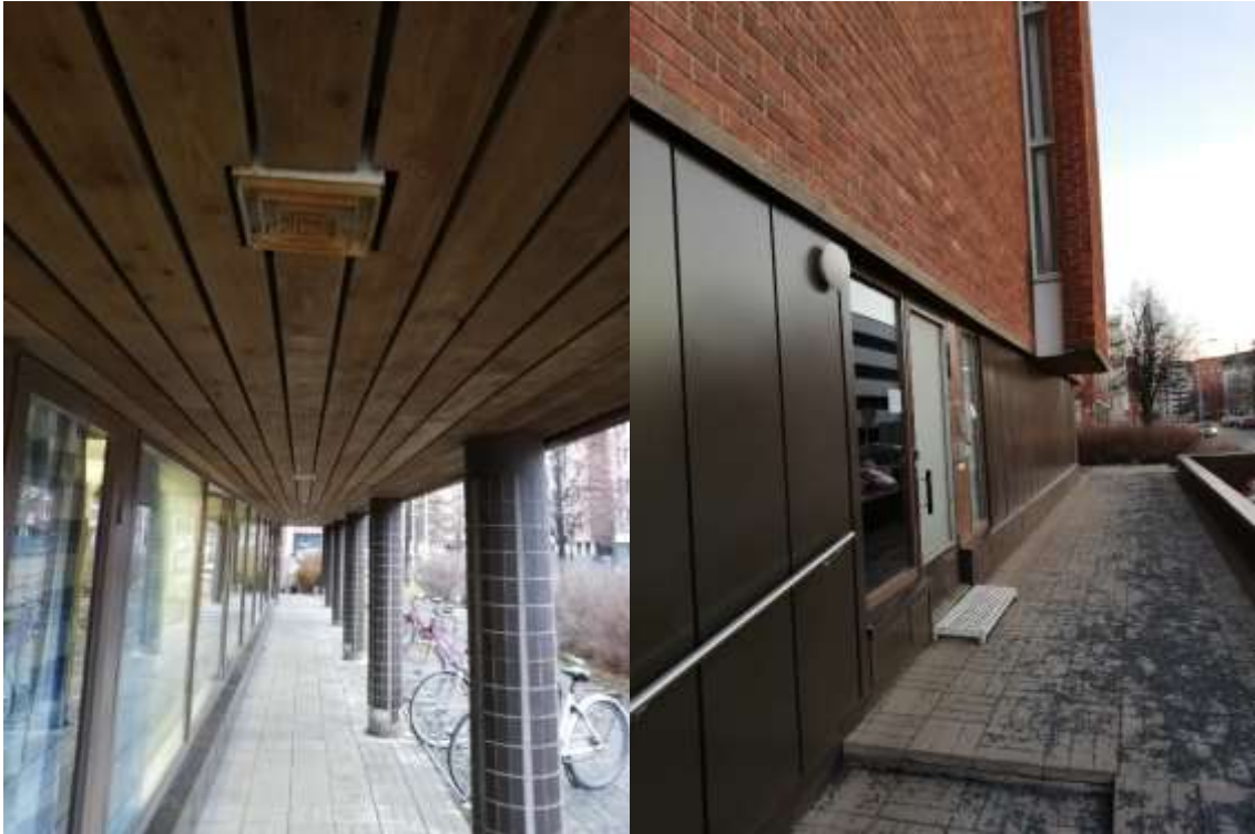
KUVA 25. Pääsisäänkäynnin valaisimet ja toimiston sisäänkäynnin valaisin
