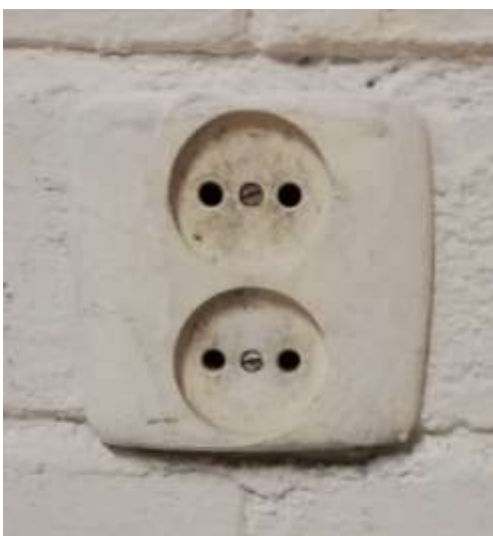
KUVA 15. 0-luokan pistorasia kierreportaiden alaosassa
