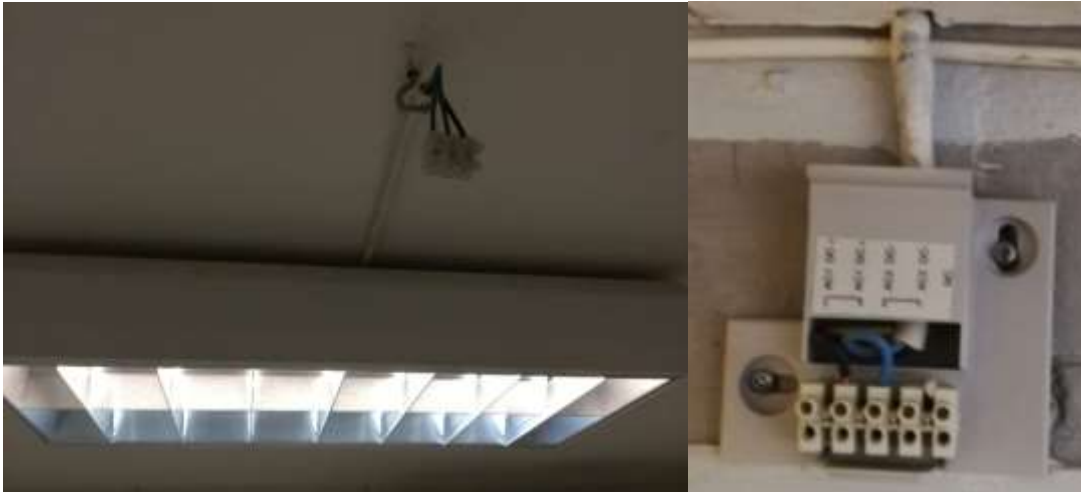
KUVA 24. Valaisimen alta tuleva kaapeli ja vanhan opastevalaisimen liitántärasia
