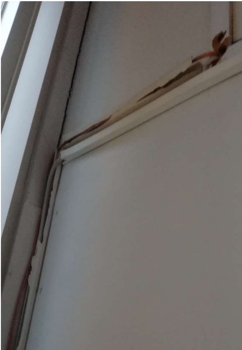
KUVA 13. Rikkinäinen asennuslista kirkkosalin portaikossa
