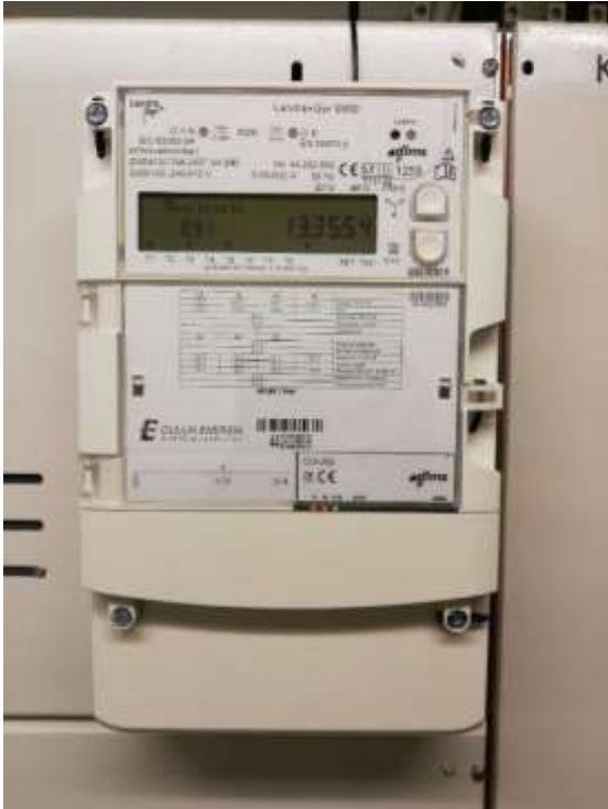
KUVA 10. kWh-mittari sähköpääkeskuksen kyljessä
