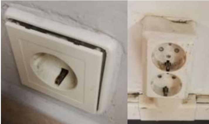
KUVA 16. Pistorasioiden irtonainen peitelevy ja rikkinäinen kotelo
