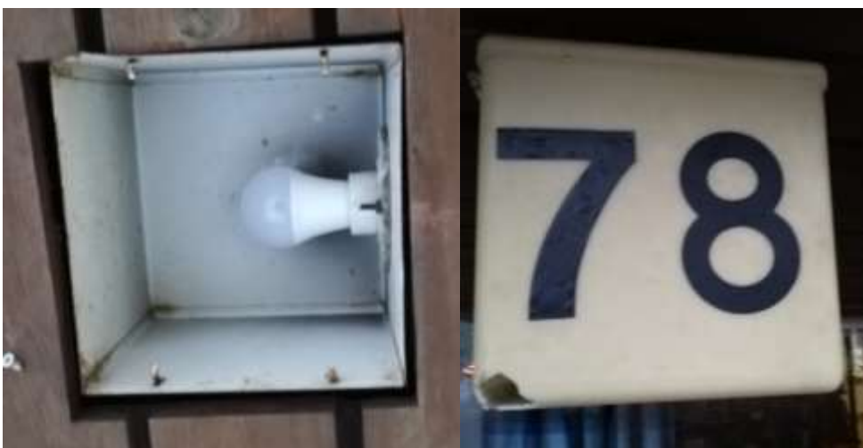
KUVA 26. Valaisimen suojaritilä puuttuu ja suojakupu on rikki
