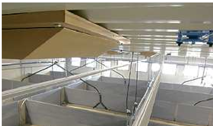
Figur 9. Bild på deltarörens placering hängande under tilluftsventilerna(Källor: Pellon Group Oy)
