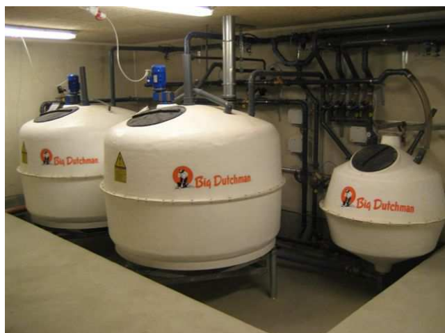
Figur 12. Exempel på ett blötfoderanläggningsblandarrum (Källa: Big Dutchman)
