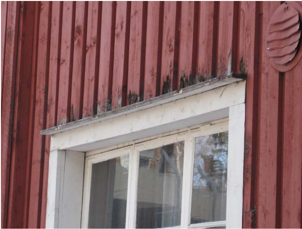
KUVA 10. Paltalinna ikkuna yläosa, vaurio
