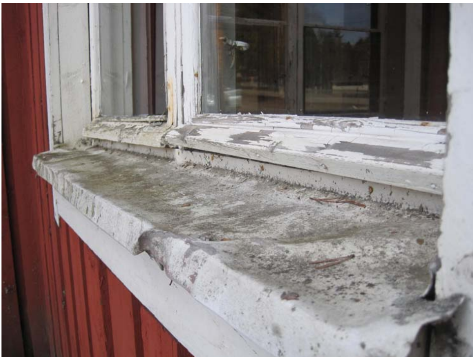
KUVA 11. Paltalinna ikkuna alaosa, vaurio
