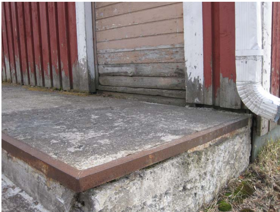
KUVA 8. Paltalinna pohjoinen sisäänkäynti, vaurio
