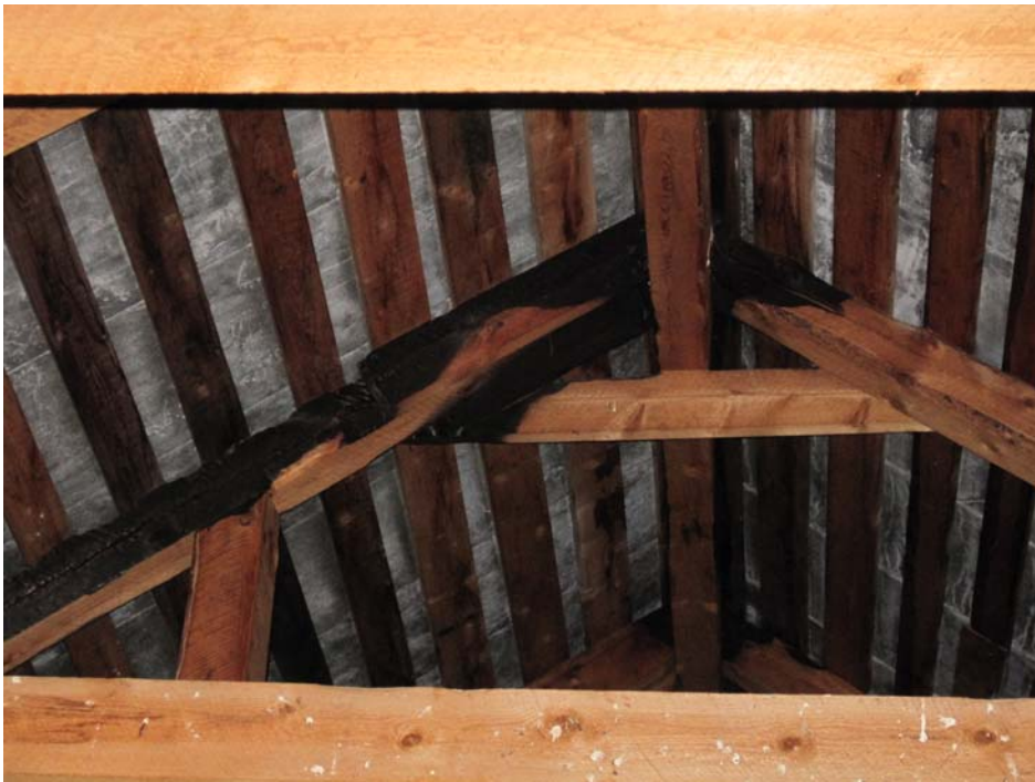
KUVA 15. Paltalinna, yläpohja, vaurio
