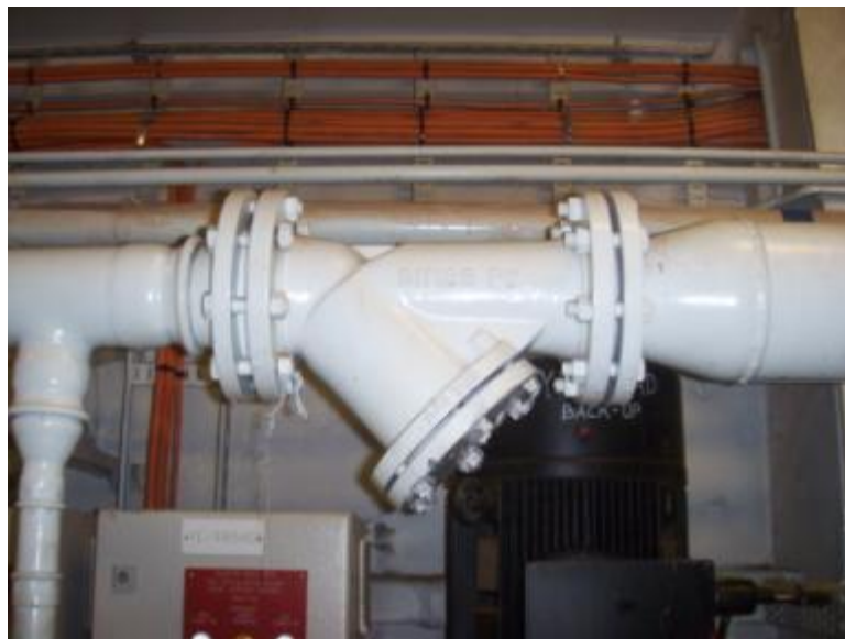
Kuva 9. Pumppujen jälkeinen suodatin.
