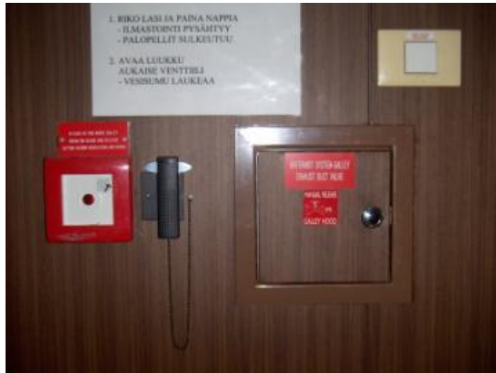
Kuva 25. Keittiön liesien poistohormien käsiventtiili.
