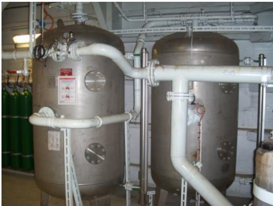
Kuva 8. Varavesisäiliöt ja lastikansien portaikkojen vyöhykeventtiilit.
