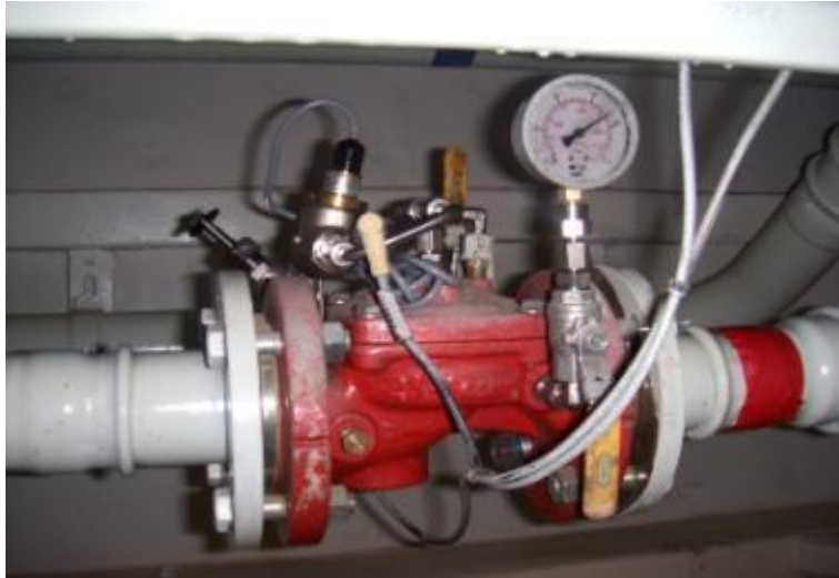
Kuva 22. Keulan portaikon vyöhykeventtiili
