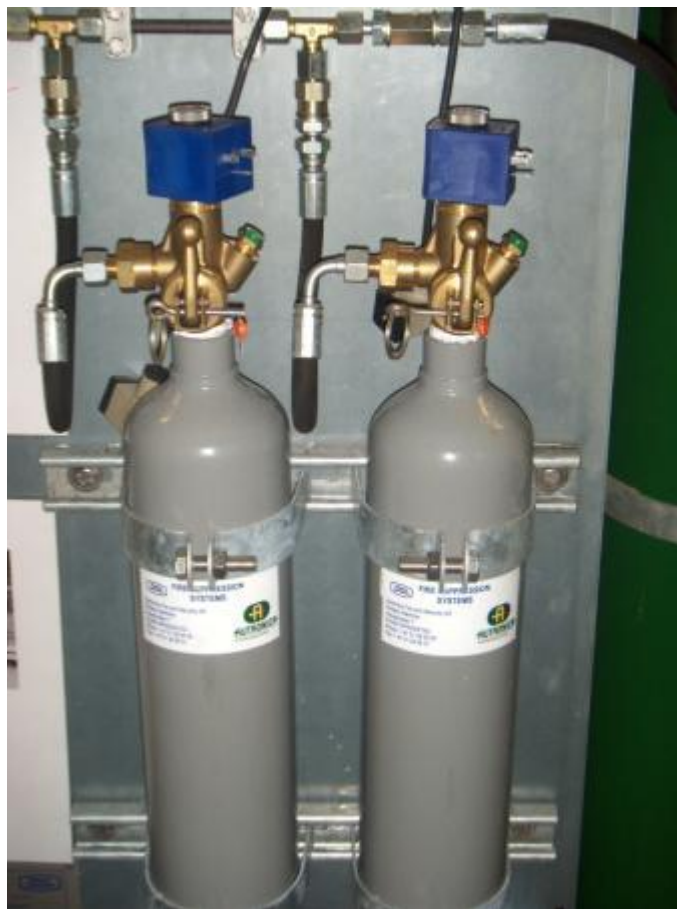
Kuva 32. Ohjausilmapullot, magneettiventtiilit on kytketty irti huollon vuoksi.
