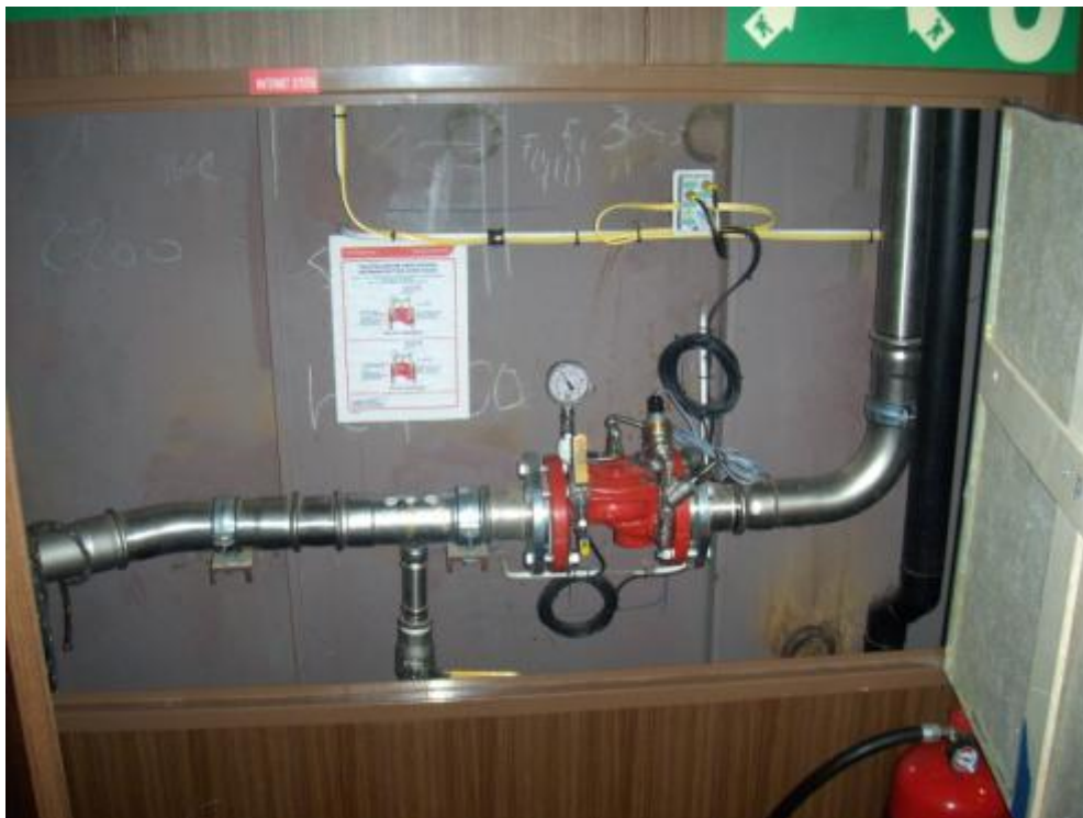
Kuva 24. Vyöhykeventtiilin kaappi sisältä.
