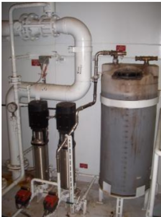
Kuva 19. Vaahtopumput ja vaahtosäiliö.
