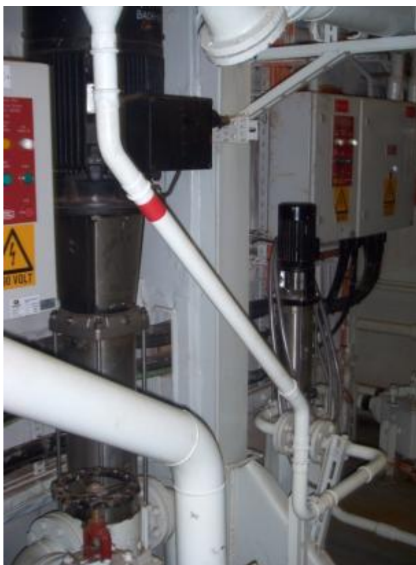
Kuva 14. Varapumppu ja Jockey- pumppu sekä käynnistyskaapit.
