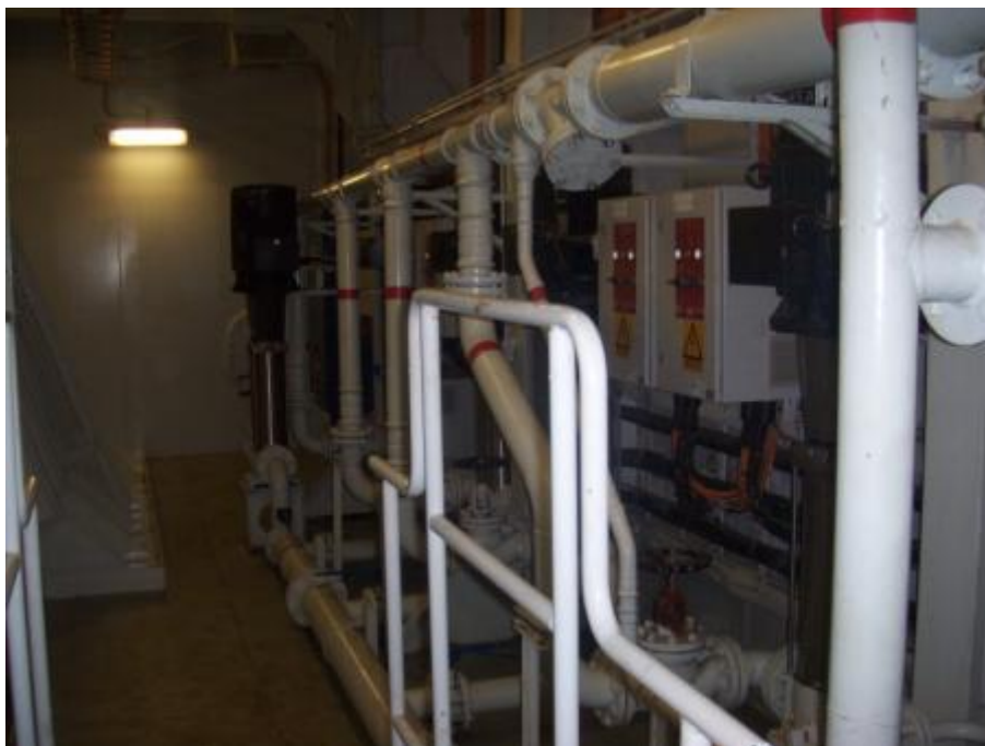
Kuva 5. FlexiFOG-pumput paapuurin vakaajahuoneessa.
