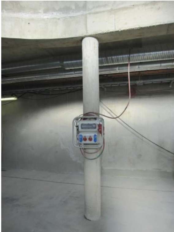
Kuva 11. Sähkökeskus asennettuna pilariin.
