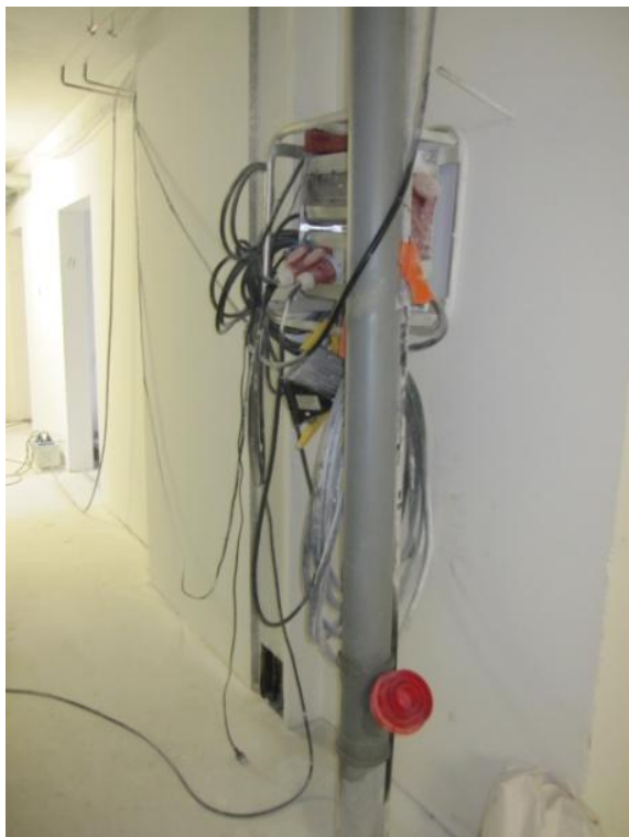
Kuva 21. Keskuspölynimurin pääputki kerroksessa.[14]
