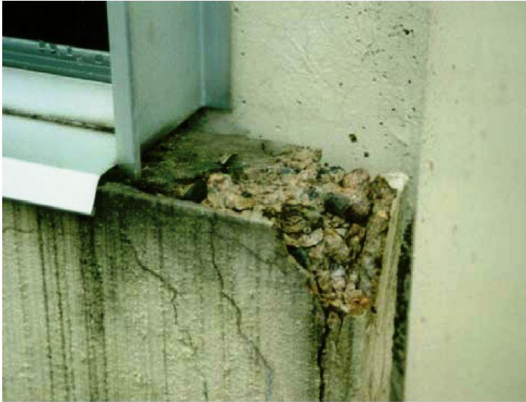
Kuva 15. Korkeasta kosteusrasituksesta johtuva pitkälle edennyt pakkasrapautuma (6.)
