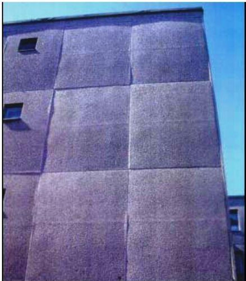
Kuva 22. Kaareutuneita pesubetonipintaisia elementtejä (6.)
