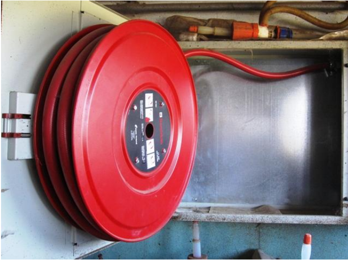
KUVA 9. Paloposti. Palopostia voi käyttää alkusammutusvälineenä sekä vesiletkun asemasta puhtaanapidossa. Palopostia asennettaessa kannattaa siis miettiä sen paikka niin, että siitä olisi mahdollisimman paljon hyötyä sekä onnettomuustilanteessa että muussa käytössä. Valokuva Anna-Riina Savolainen 2011.
