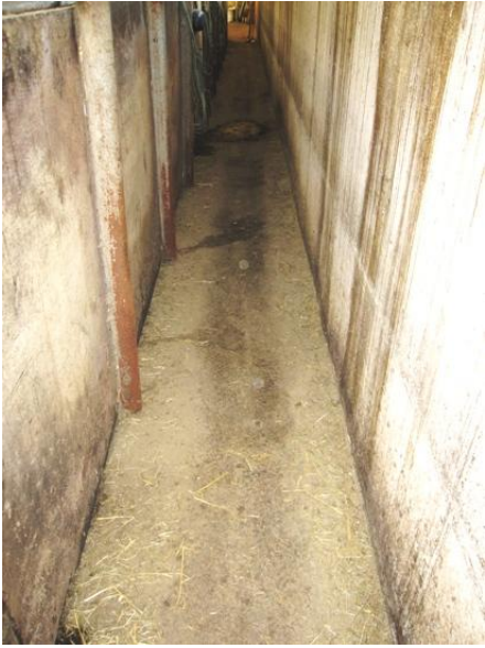
KUVA 4. Navetan käytävä. Tällaisia käytävien tulisi olla; vapaita turhasta romusta, jotta kulkeminen on turvallista. Valokuva Anna-Riina Savolainen 2011.
