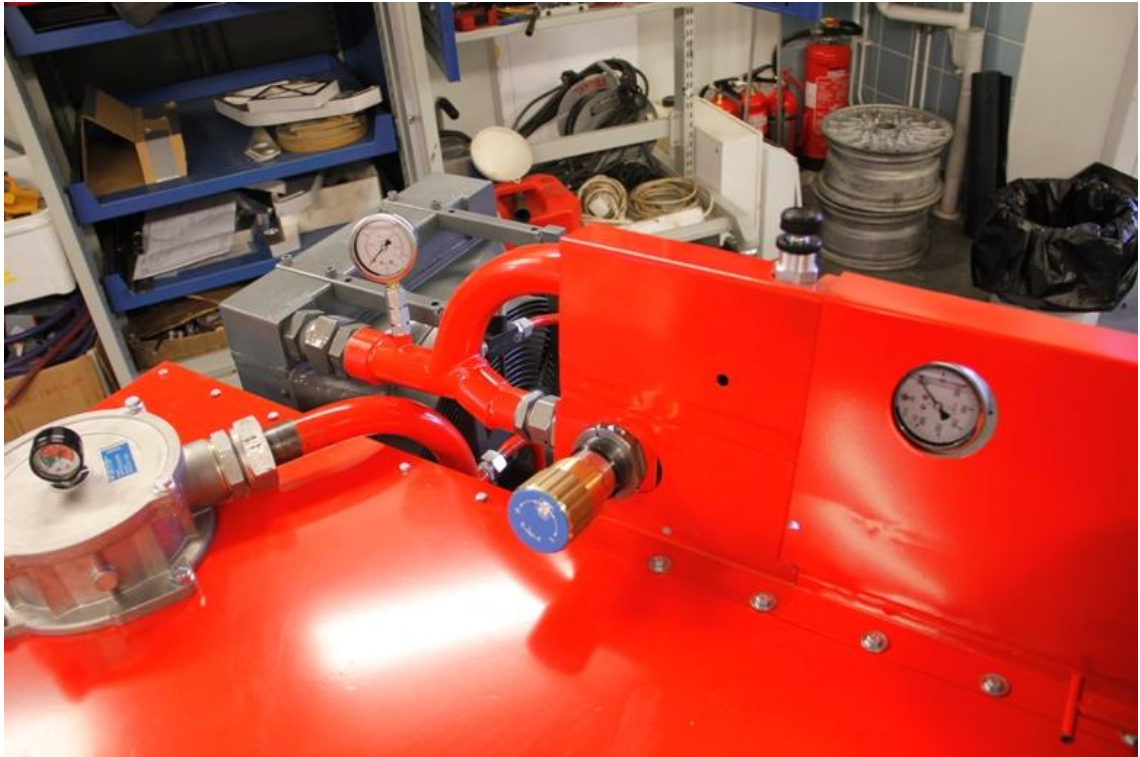
KUVA 27. Hydrauliikan mittarit ja hallintalaitteet
