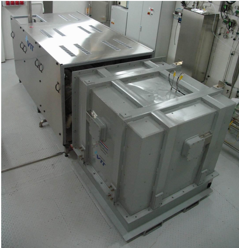
Kuva 20: VTT:n 10 kW:n maakaasukäyttöinen SOFC Otaniemessä.
