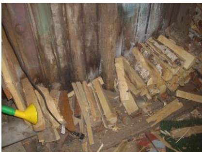
KUVA 14. Kosteusvaurio rungon alaosassa.
