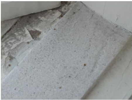
KUVA 8. Ikkunoiden maalipinta tulisi uusida. Muilta osin ikkunat ovat hyväkuntoisia.
