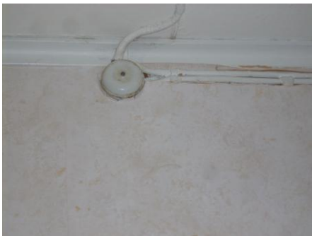
Kiinteistön sähköistyksessä on parantamisen varaa
