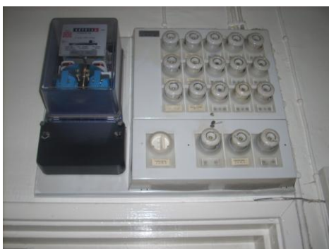
KUVA 20. Sähköpääkeskus tulee uusittavaksi lähiaikoina.
