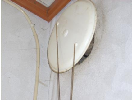
KUVA 18. Poistoilmavaihtventtiili on kiinnitetty muurattuun hormiin.
