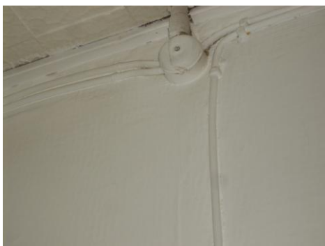
KUVA 19. Sähköasennukset ovat osittain alkuperäisiä.
