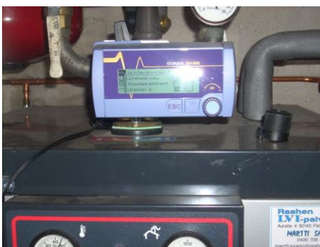
KUVA 15. Verkostossa on automaattinen lämmönsäädin.
