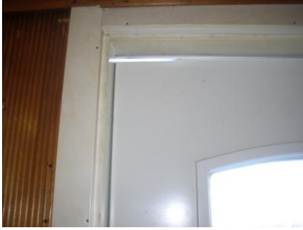
KUVA 4. Kuistilla esiintyy routaliikettä.
