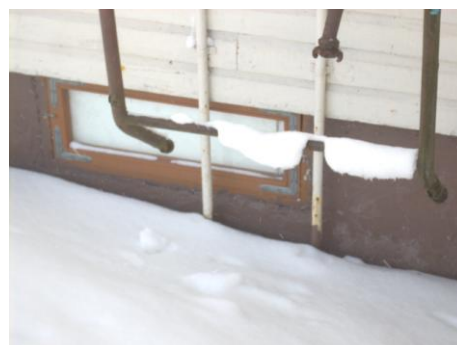
Alapohjan tuuletukseen tarkoitetut ilmanottoaukot on talven ajaksi peitetty väliaikaisella ikkunoilla
