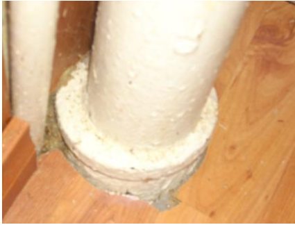
KUVA 17. Rakennuksen sisäpuolinen viemärointi on osittain valurautainen.
