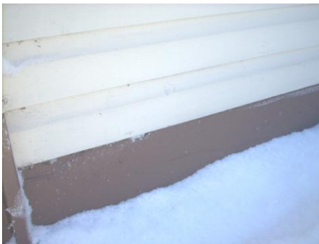
KUVA 7. Ulkoseinästä puuttuu tuuletusrako.
