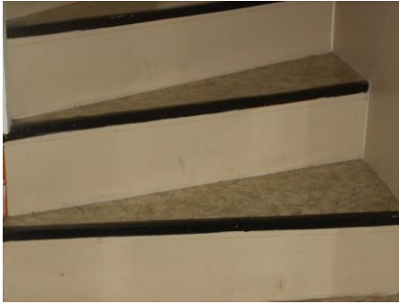
KUVA 6. Porrasaskelmat eivät täytä nykyisiä määräyksiä (RT – 10854/ RakMK C2).
