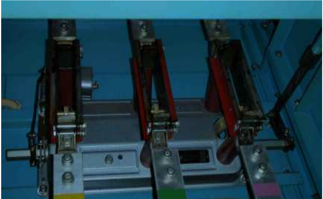
KUVA 8. Erottimen punaiset veitset helpottavat niiden havaitsemista kojeistossa.
