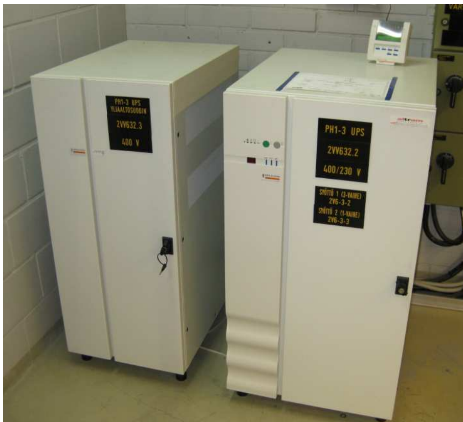
KUVA 20. Ristikytkenässä 2RK2 olevalla Merling Gerlinin UPS:illa varmennetaan hiomon automaatiojärjestelmien sähkönsyöttö
