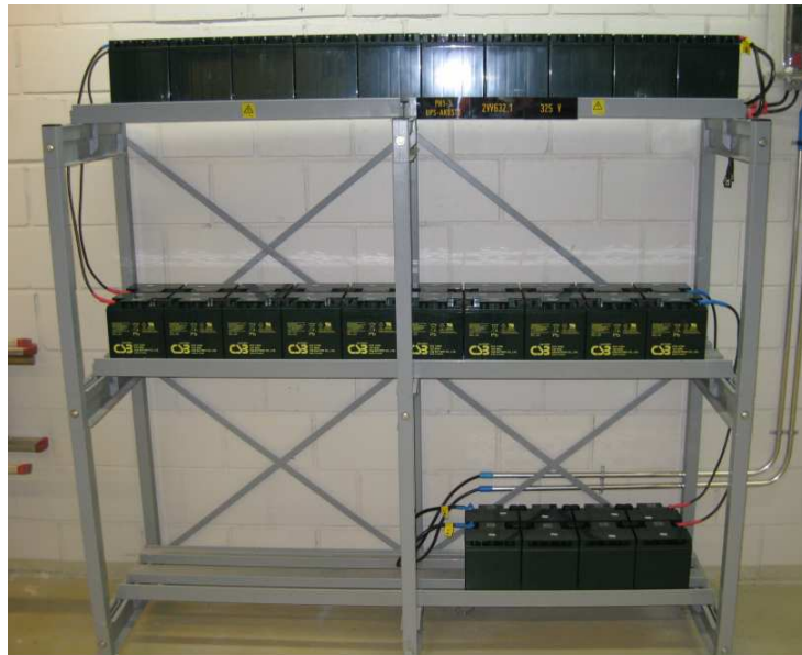
KUVA 21. CSB:n suljettuja lyijyakkuja, sijoitettuna telineeseen ristikytkennässä 2RK2
