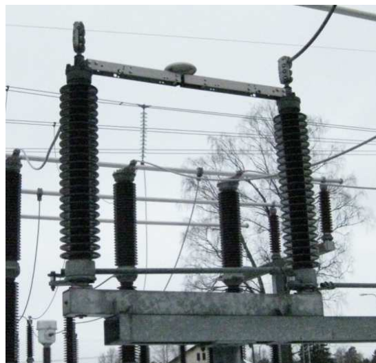
KUVA 6. Myllykosken 110 kV:n ulkokentällä käytetään kieroerottimia
