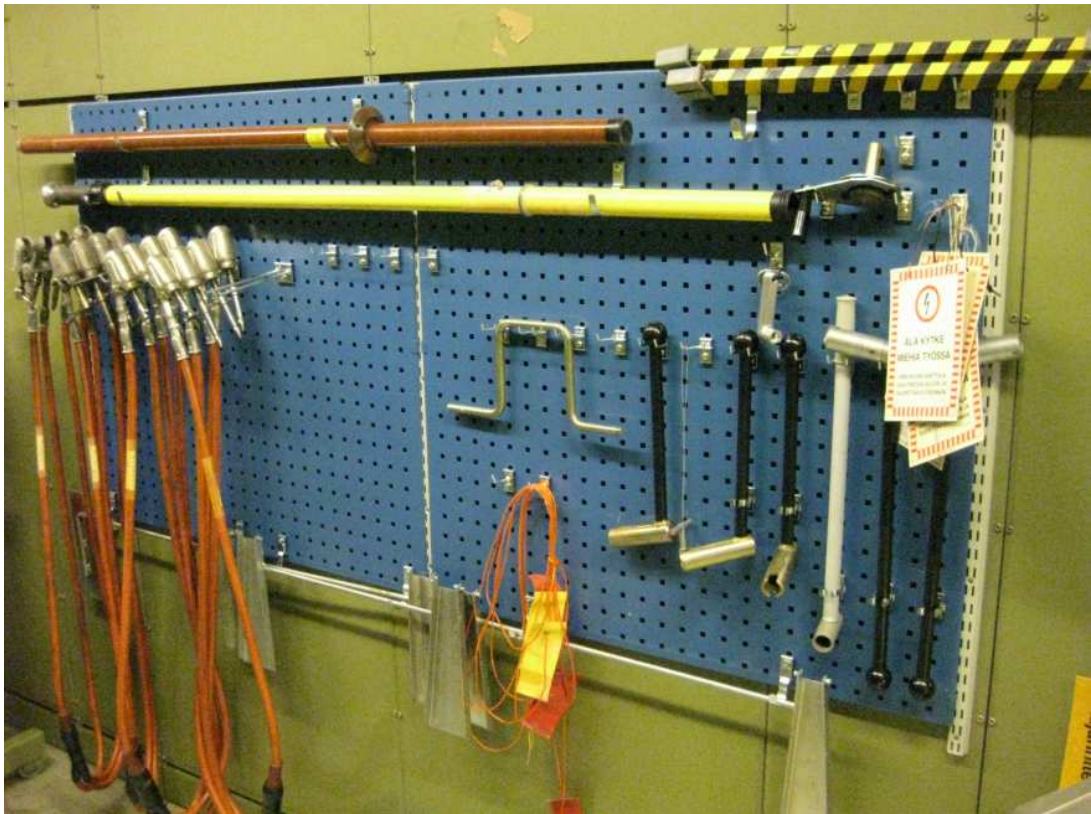
KUVA 26. Kytkennoissä käytettävät työvälineet ja tarvikkeet pitää olla selvästi esillä sekä helposti saatavilla.
