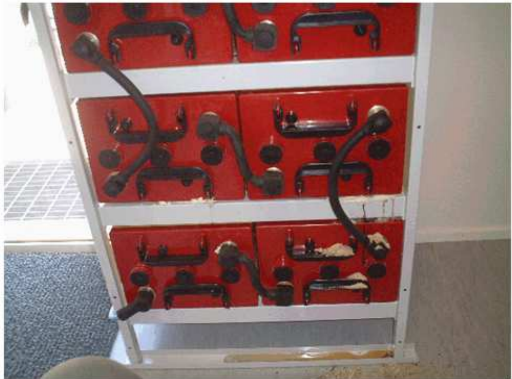
KUVA 23. Sähkötilassa vioittunut akku, jossa kotelo vuotaa.
