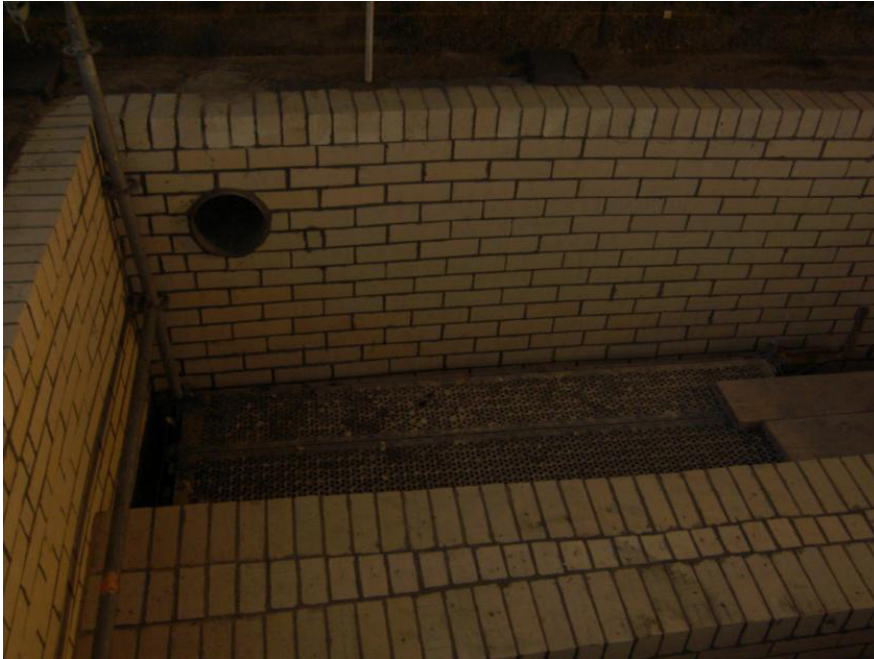
Kuva 10. “Dividing wall in a Sulfur melting pit” (Forström M. 2011)
