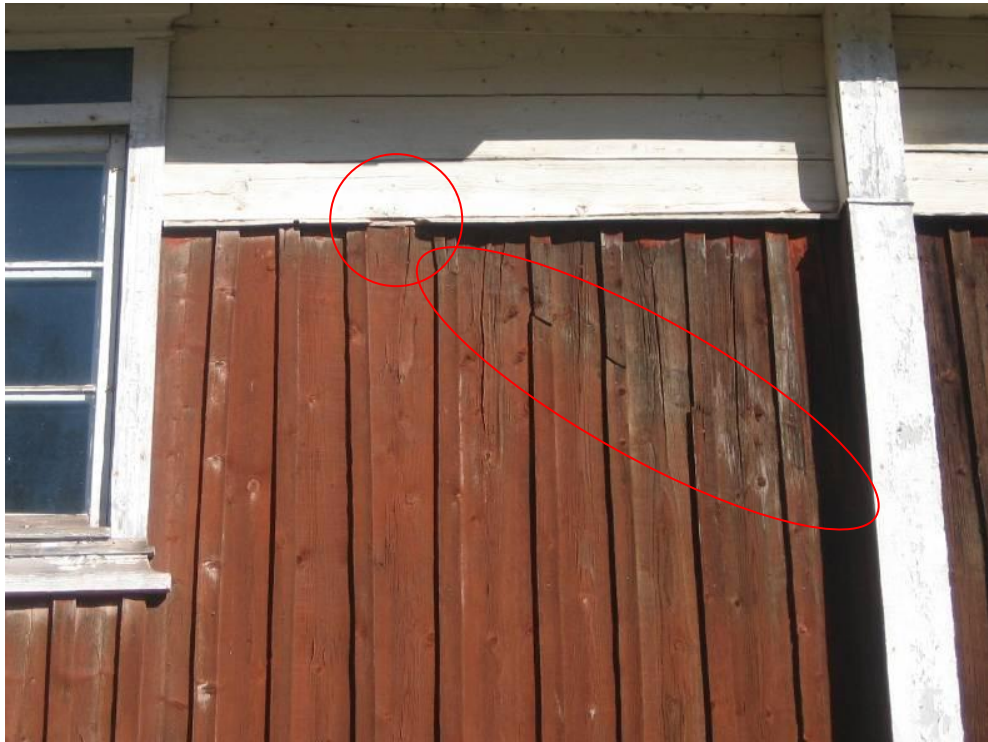
Kuva 12. Vaakalaudoituksen alareunan vaakalistassa on kolot sekä ulkovuorauksen pystyrimoissa jatkoskohdat.
