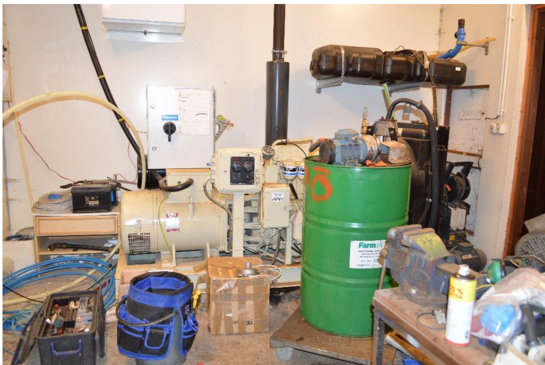
KUVA 22. Navetan tekninen tila 1. (Rissanen 2019-01-02.)
