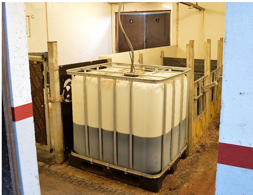
KUVA 18. Energianesterehu kontti paikallaan (Rissanen 2019-06-06.)
