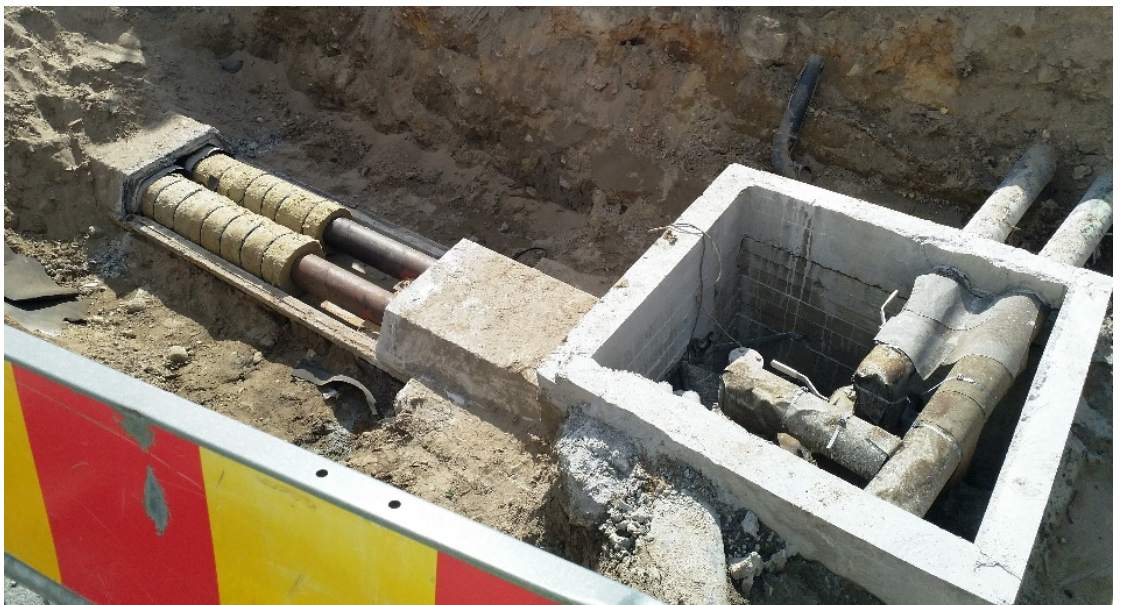
KUVA 3. Saneerattava betonikanavajohto ja kaivo, jonka betonikansi on irrotettu (Heikkinen 2019-08-16).
