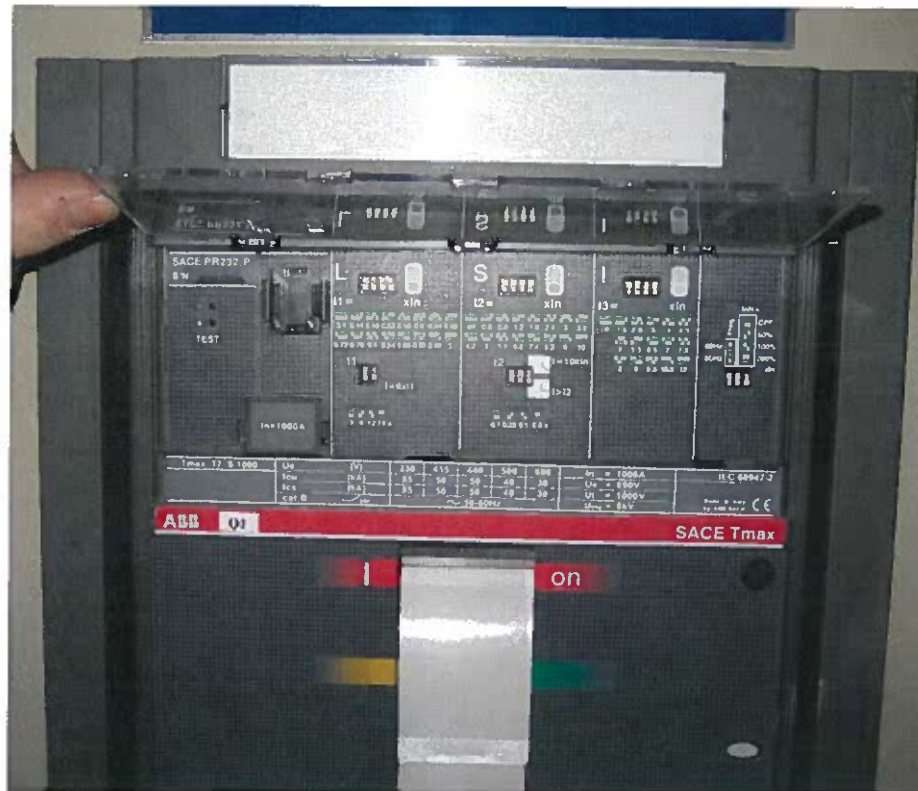
Kuva 17. Kojeston pääkatkaisijan suojarahit
