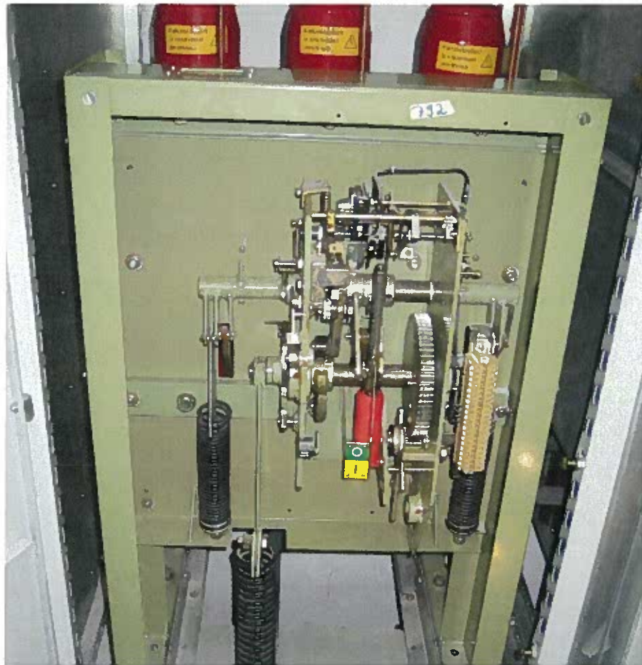
Kuva 14. Katkaisijan koneisto on avattu huollon yhteydessä
