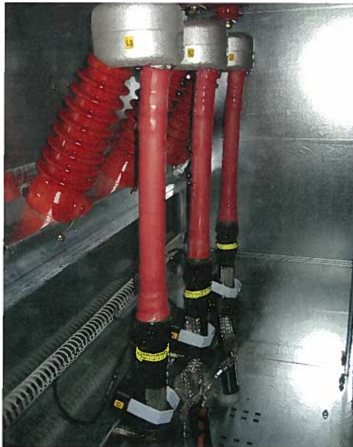
Kuva 1. Keskijänniteverkon liittymiskaapeli AHXAMK-W 3 \times 240 \text{ mm}^2 liittymäkennossa
