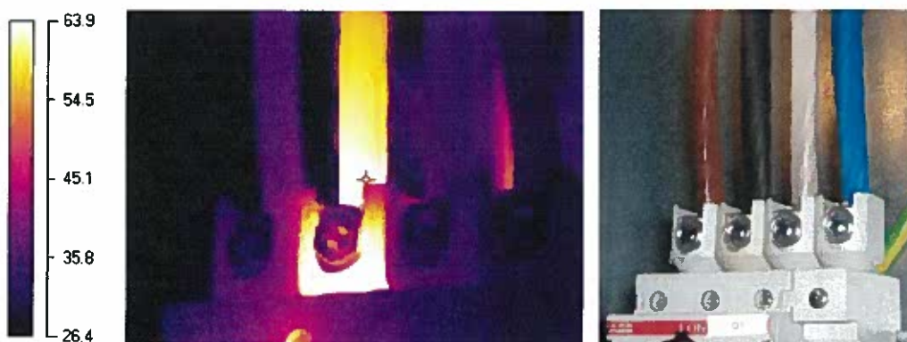
Kuva 24. Löysä liitos keskuksen syöttöliittimessä
