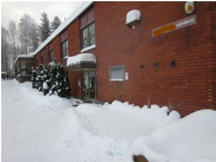
Kuva 5. Päiväkodissa 5 ilmanottoaukko on huoltoajoreitin kohdalla.
