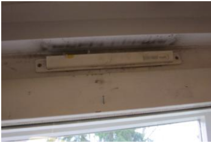
Kuva 1. Päiväkodissa 10 ulkoilmaventtiileiden suodattimet oli poistettu. Ulkoilman epäpuhtaudet olivat värjänneet venttiilin ympäristön mustaksi. Ilmavirtauksesta aiheutui vetoa.
