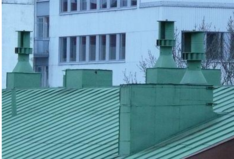
Kuva 15. Ilmastointitekniikassa käytettäviä Savonius-turbiineita talon katolla. [18]
