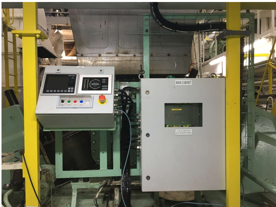
Kuva 15. Asennettu Pääkeskus ja LCP (Oma kuva Queen Mary 2)
