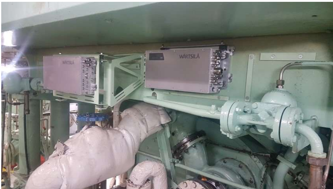
Kuva 11. Asennetut kaapeliradat ja moduulit. (Oma valokuva Queen Mary 2)
