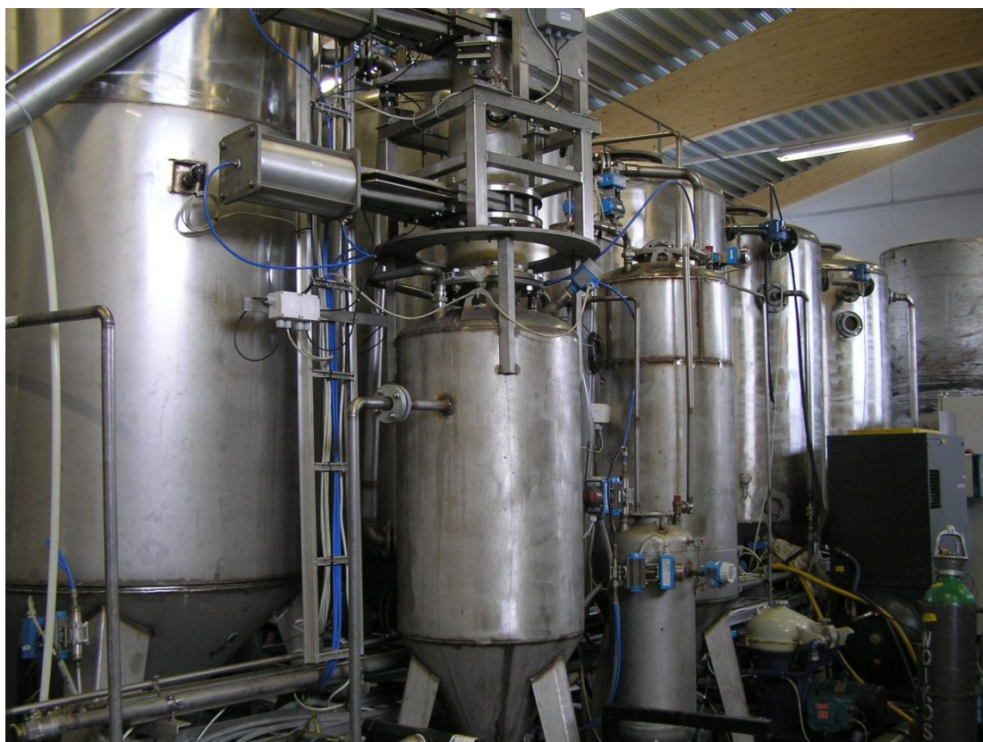
Kuva 2: Rovina Oy:n monivaiheinen esteröintilaitteisto
