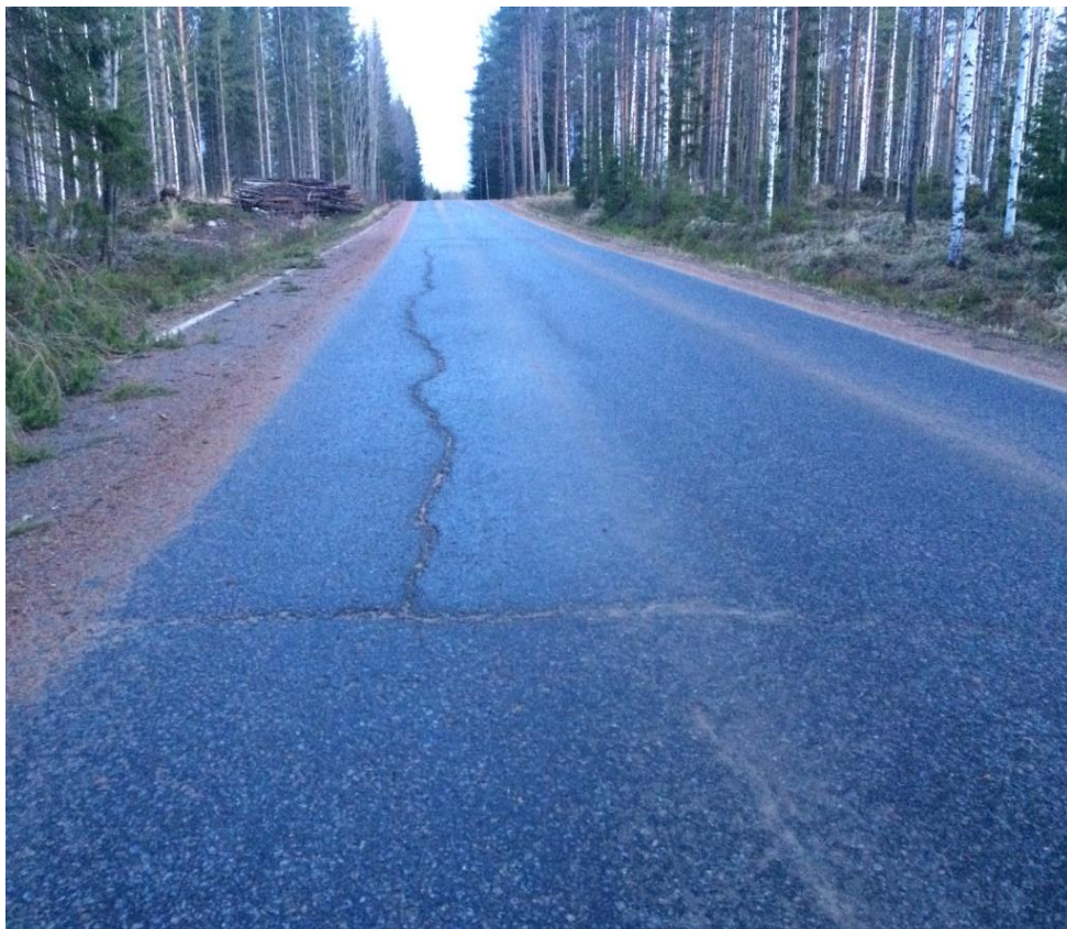
Kuva 5. Seututiellä pitkittäis- ja poikittaishalkeamia.
