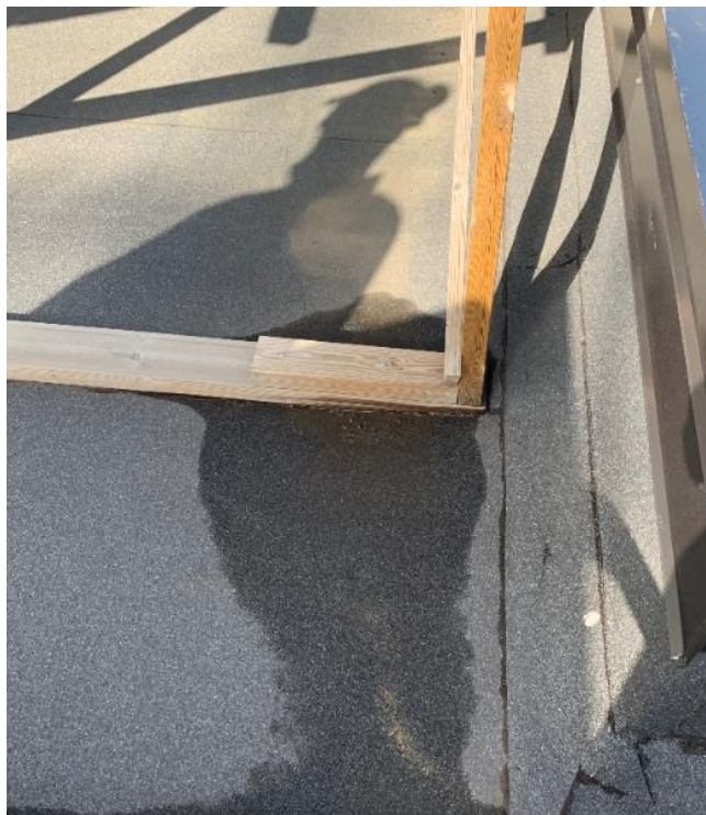
Kuva 14. Rakenteiden elämistä bitumikatolla (STEP 2019)
