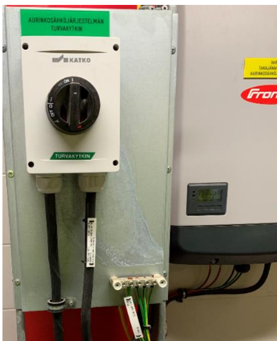
Kuva 13. Järjestelmän invertteri ja turvakytkin (STEP 2019)
