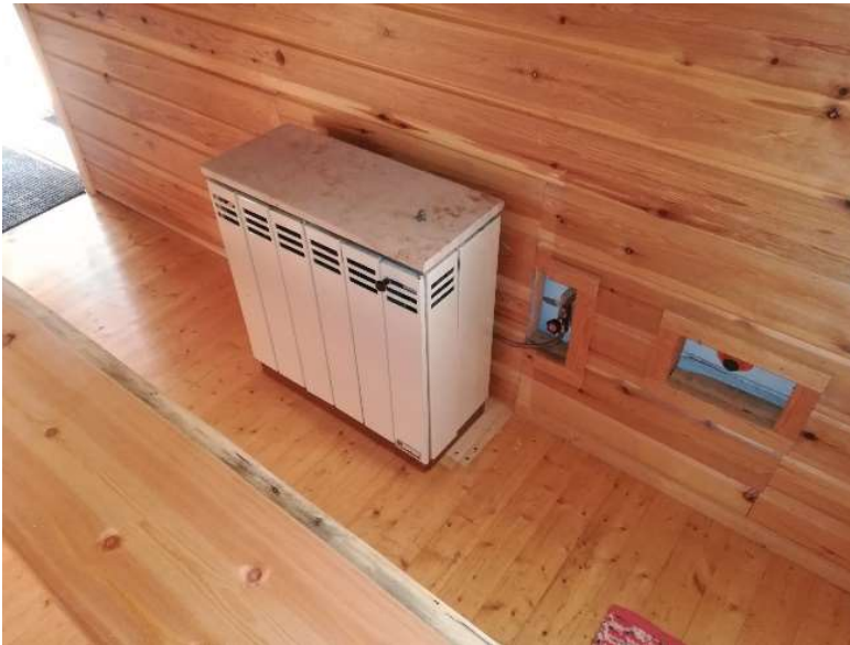
KUVA 2. Nestekaasulämmittin pirtin seinällä
