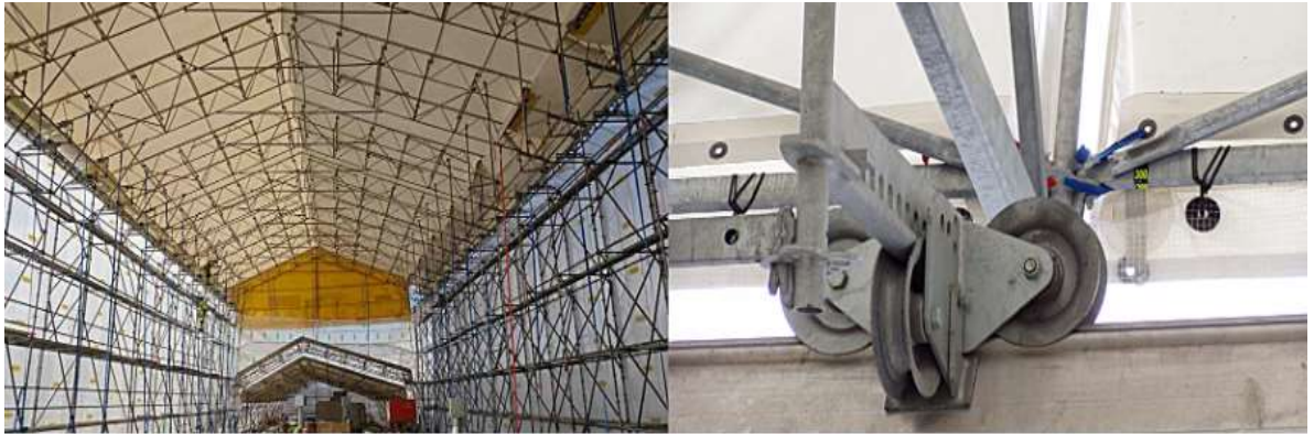
Kuva 17. Sääsuojat siirtokiskoilla (Ramirent, palvelut).
