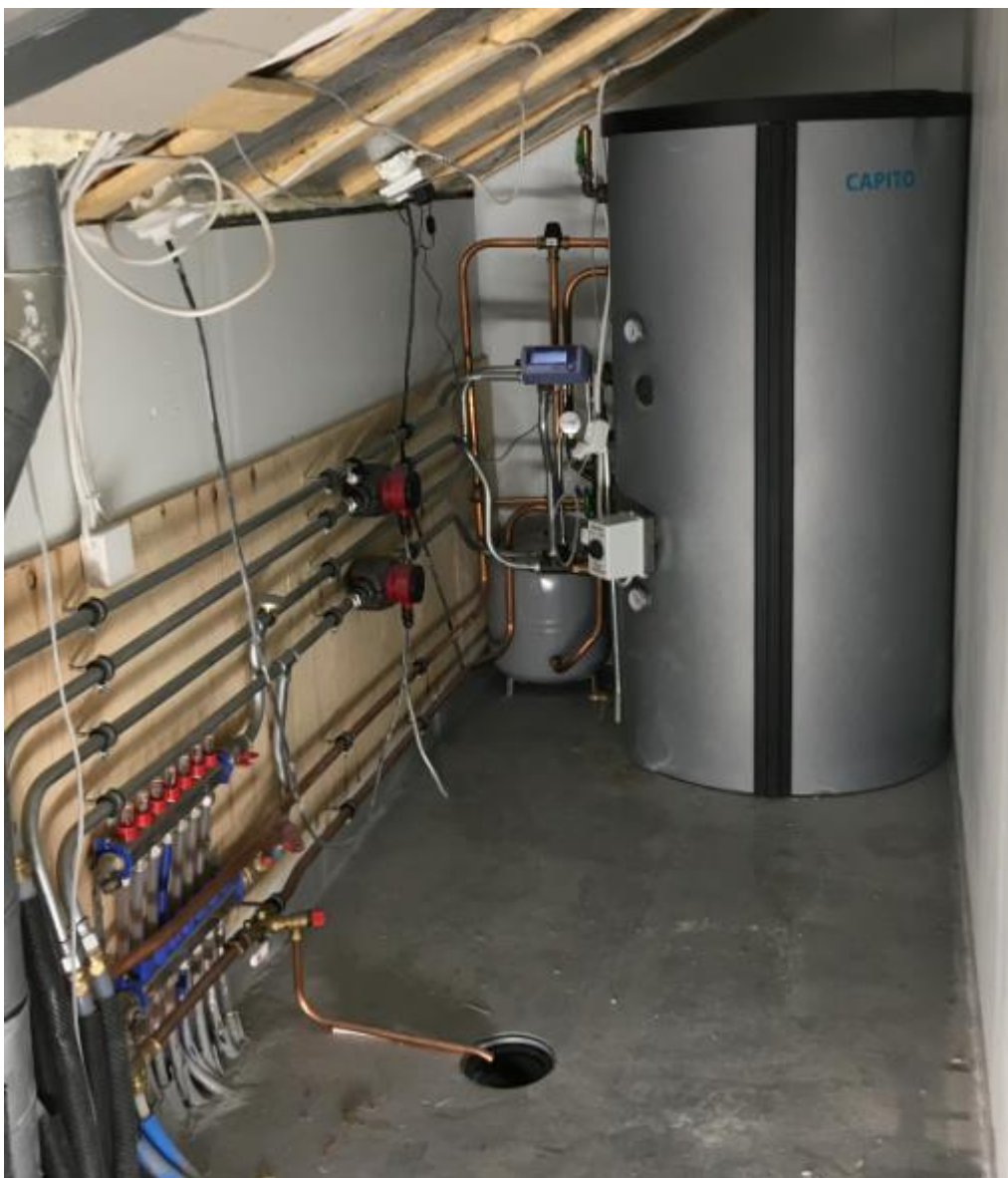
KUVA 1. Yläkertaan sijoitettu tekninentila
