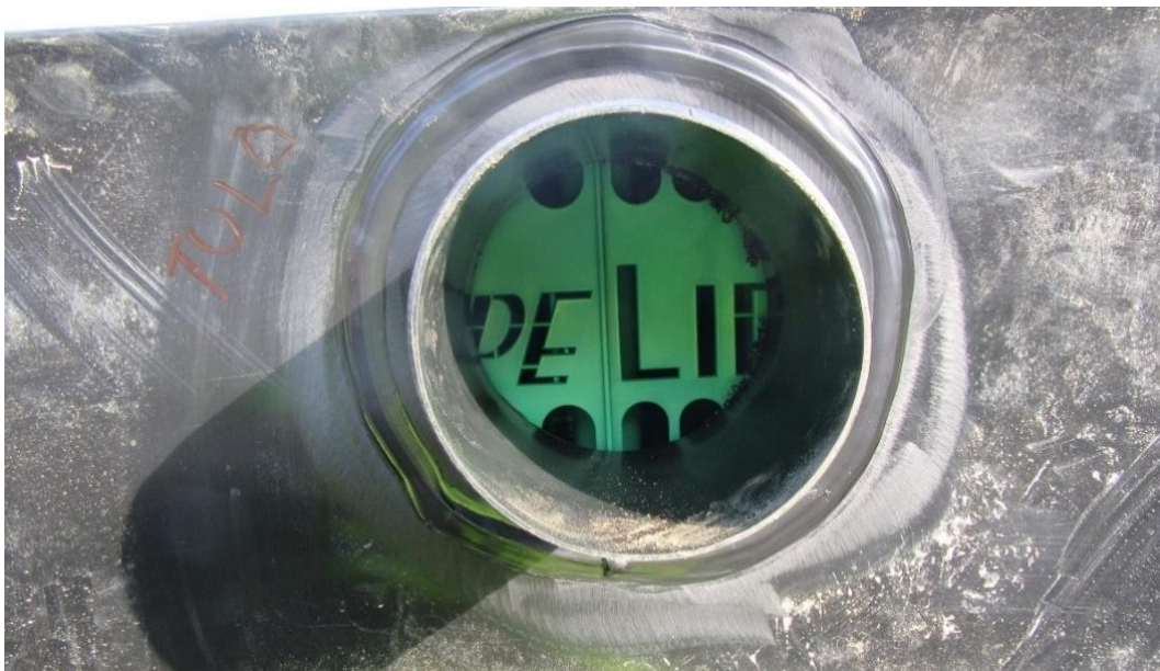
Kuva 9. Virheellisesti hitsattu putkiyhde. (Kuva Ville Jalkanen).
