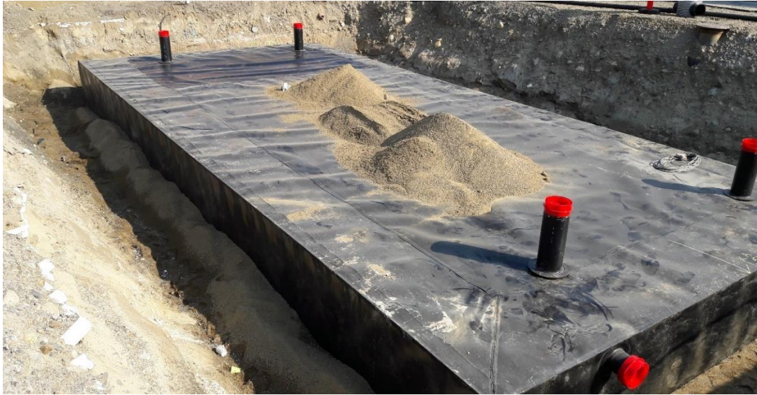
Kuva 10. Valmis viivytyskenttä, hitsatulla PE- kalvolla, asennusvirheet korjattuna. [19]
