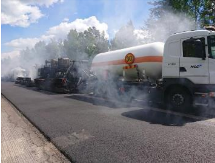
Kuva 2. REM, REM+ ja MPKJ -pintauksissa käytettävä nestekaasulämmitin
