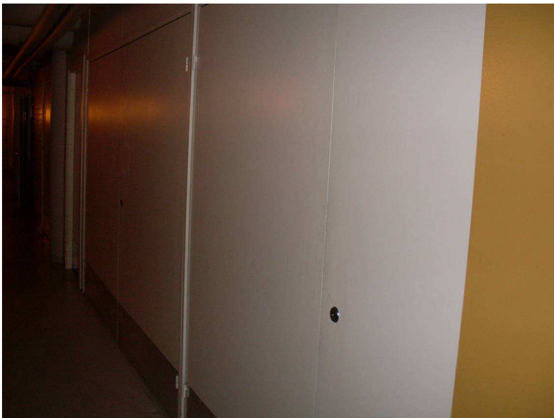
Kuva 17. Keskus sijaitsee käytävällä isojen ovien takana
