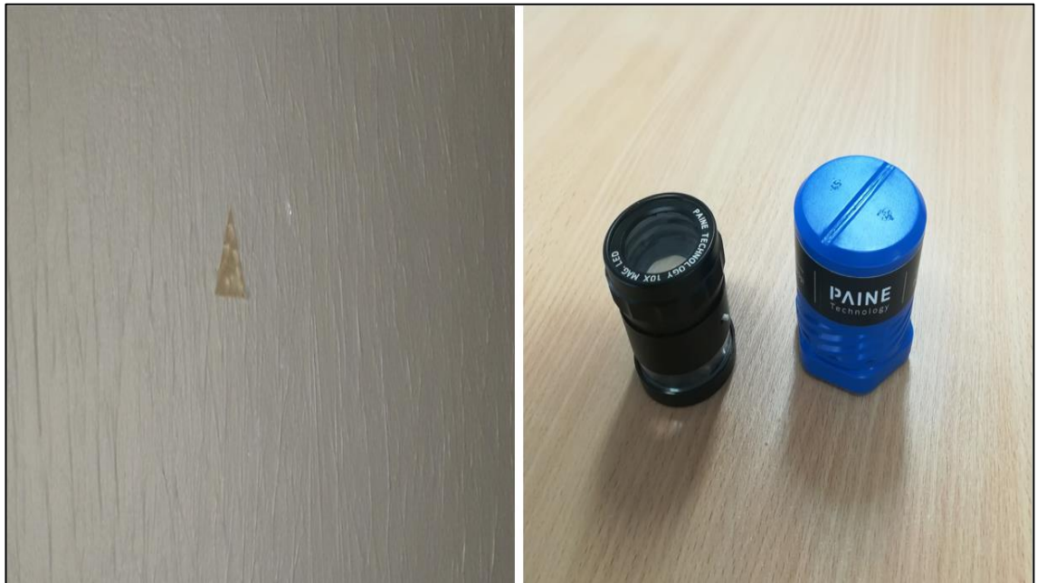
Kuva 7. Vasemmalla seinän vedeneristyksestä otetun näytepalan paikka seinässä. Kolmion si- vun pituus tulee olla vähintään 3 cm. Oikealla vedeneristykseen kuivakalvopaksuuden varm- istuksessa käytetty Paine Technologyn luuppi.
