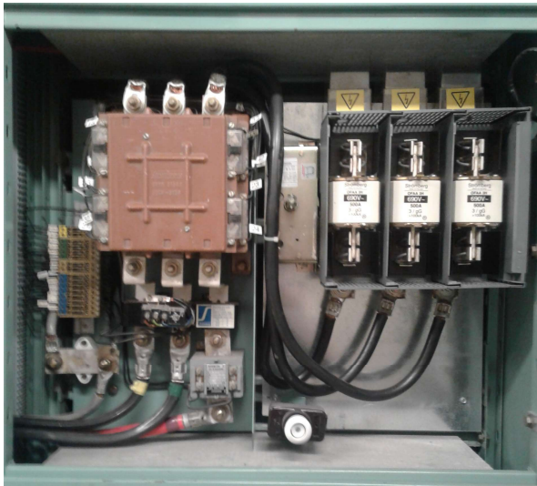
Kuva 4. PVP62-moottorilähdönpääkontaktori, kahvavaroke ja lämpörele
